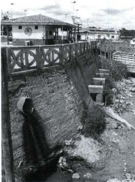
Figura 21. Lançamento de esgotos pela rede de drenagem pluvial – Vitória do Xingu.
