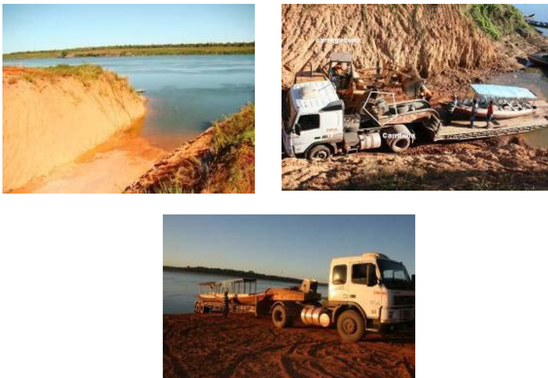
FIGURA 1.4.2-6 – Fotos ilustrativas do modelo de dispositivo provisório de transposição de embarcações a ser utilizado durante a etapa de construção da UHE Belo Monte
