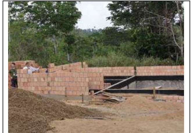
Foto 28 Execução das obras na EMEF Vila Rica, na zona rural do município de Vitória do Xingu
