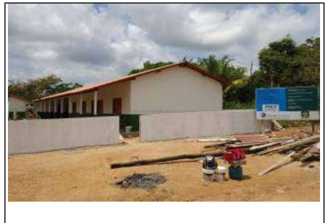
Foto 30 Obra na Escola N.Sª Aparecida III, na zona rural do município de Vitória do Xingu
