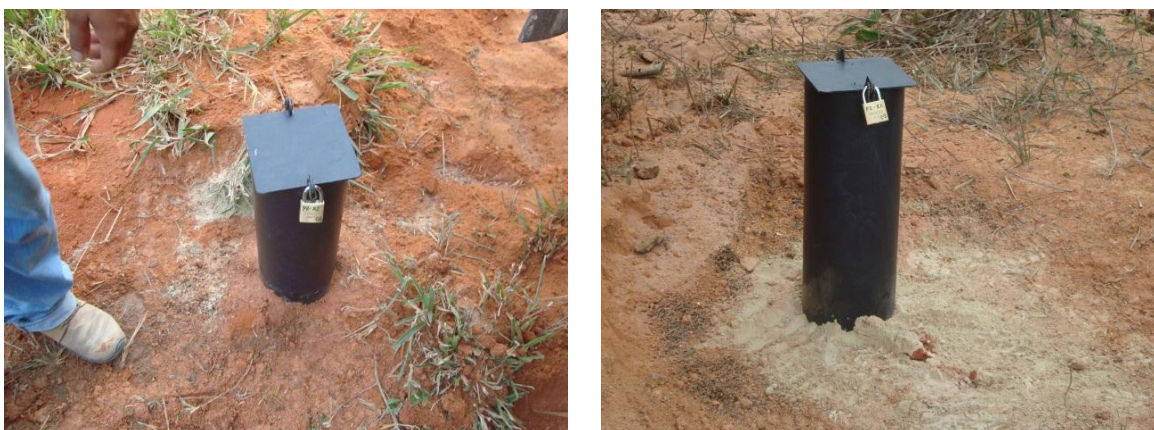
Figura 11.3.1 - 1 – Exemplos de proteção dos poços instalados, composta por tubo metálico provido de tampa e cadeado.
