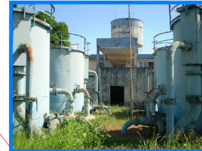
VISTA GERAL DAS UNIDADES DE TRATAMENTO
