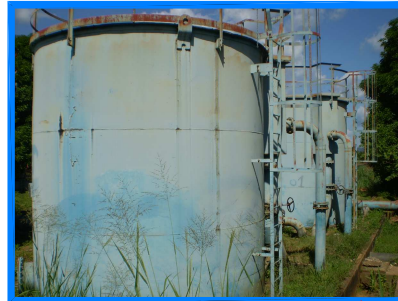
VISTA DOS FILTROS METÁLICOS DE FLUXO ASCENDENTE
