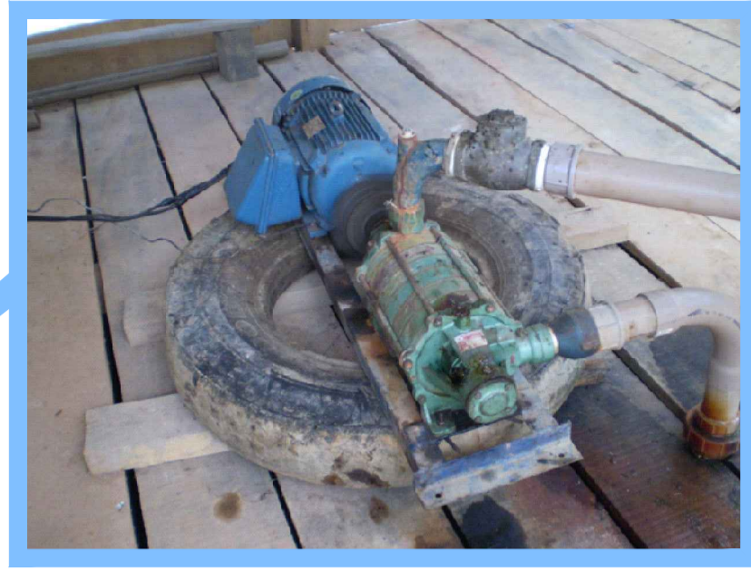
SISTEMA DE BOMBAMENTO DO POÇO
