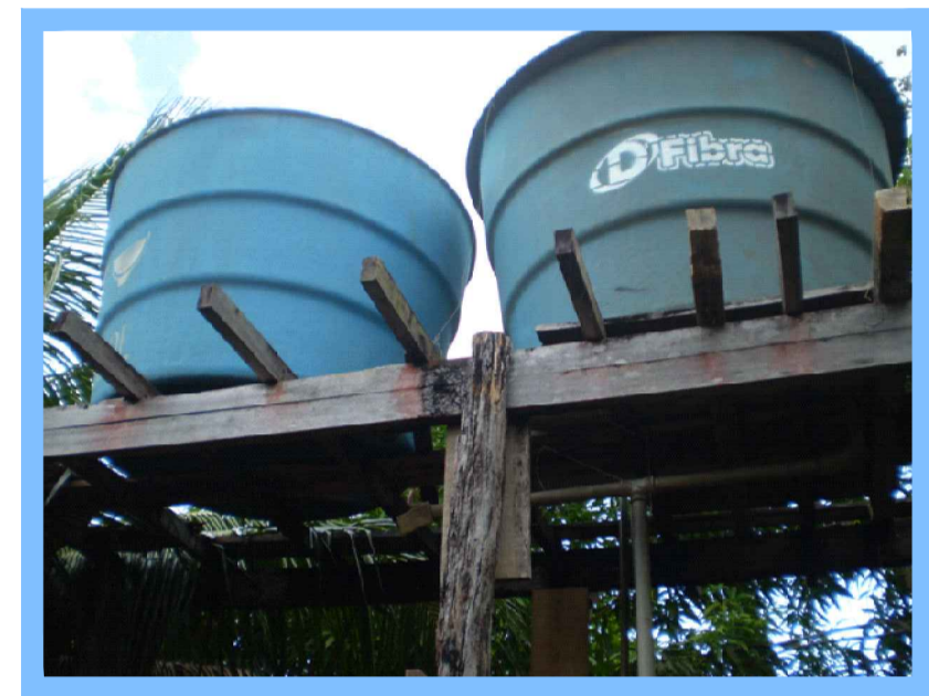
RESERVATÓRIO 2 - ELEVADO 2x3m 3
