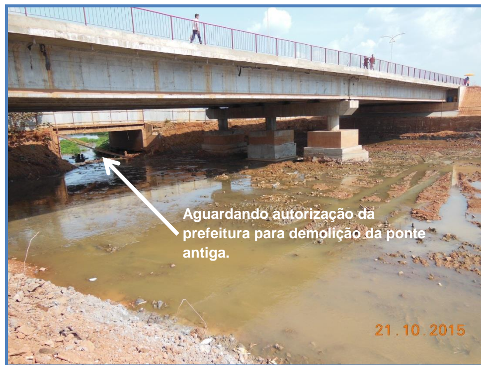
Figura 02 – Ponte João Coelho (Aguardando autorização da prefeitura para demolição da ponte antiga)
