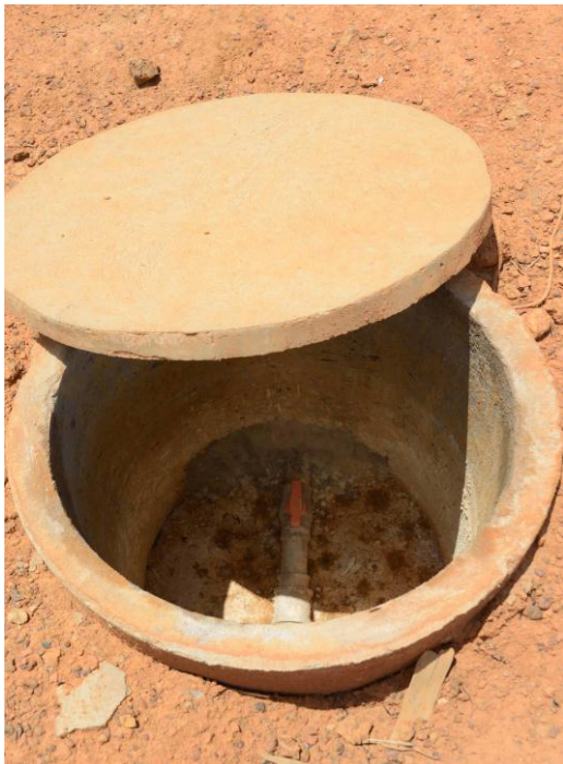
Figura 2-11 – Estrutura componente do sistema de abastecimento de água na localidade Vila da Ressaca
