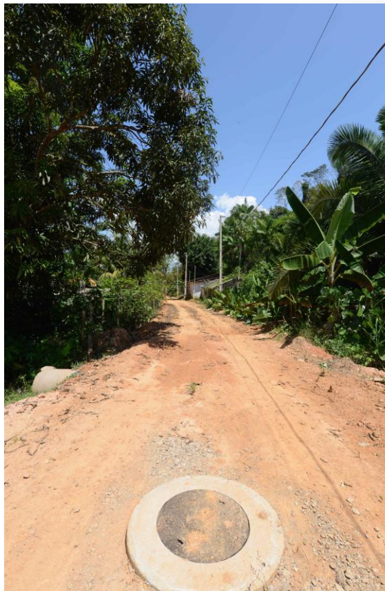
Figura 2-18 – Estrutura integrante do sistema de abastecimento de água implantado na localidade Garimpo do Galo
