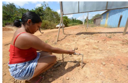
Figura 2-6 – Ponto da rede de distribuição do sistema de abastecimento de água implantado pela Norte Energia na localidade Vila da Ressaca
