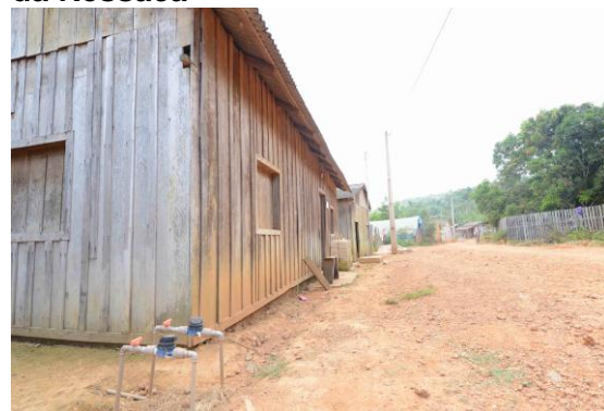
Figura 2-8 – Pontos da rede de distribuição do sistema de abastecimento de água na localidade Vila da Ressaca
