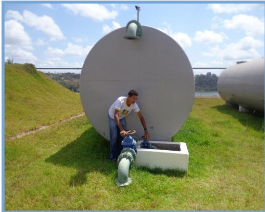
Figura 3-13 – Treinamento do técnico da Prefeitura de Vitória do Xingu encarregado da operação do SAA da Vila de Belo Monte
