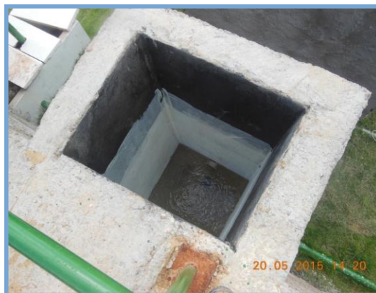
Figura 3-10 – Estação de Tratamento de Água integrante do sistema de abastecimento de água da Vila de Belo Monte do Pontal
