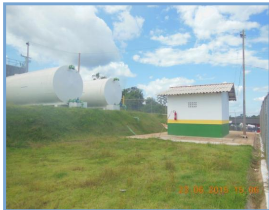
Figura 3-5 – Reservatórios apoiados integrantes do sistema de abastecimento de água da Vila de Belo Monte do Pontal
