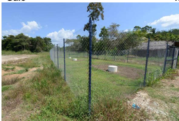
Figura 2-20 – Estruturas integrantes do sistema de tratamento de esgoto implantado na localidade Garimpo do Galo
