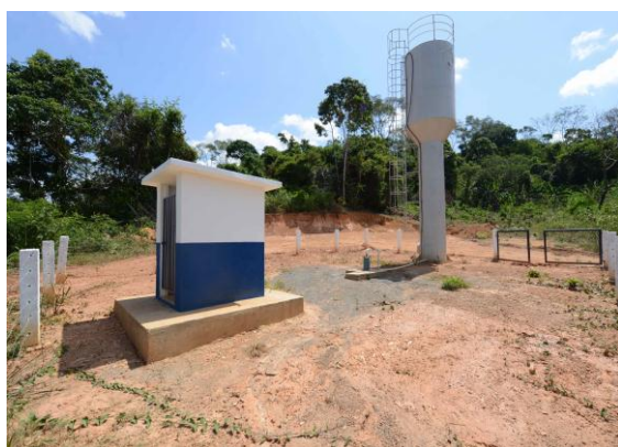
Figura 2-16 – Reservatório integrante do sistema de abastecimento de água implantado na localidade Garimpo do Galo
