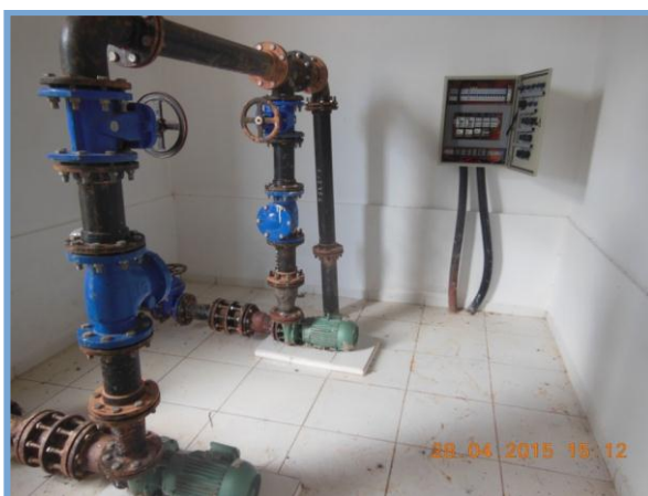
Figura 3-7 – Sistema hidromecânico integrante do sistema de abastecimento de água da Vila de Belo Monte do Pontal
