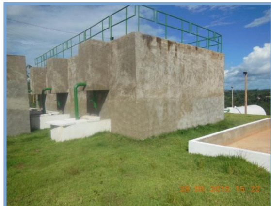
Figura 3-6 – Caixa de saída e dosadora química integrante do sistema de abastecimento de água da Vila de Belo Monte do Pontal
