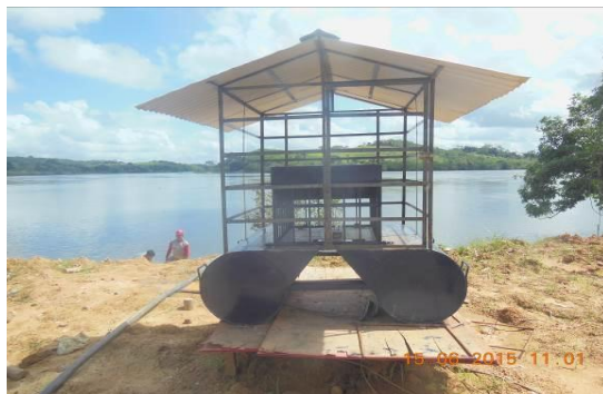
Figura 2-5 – Captação de água integrante do sistema de abastecimento de água na localidade Vila da Ressaca
