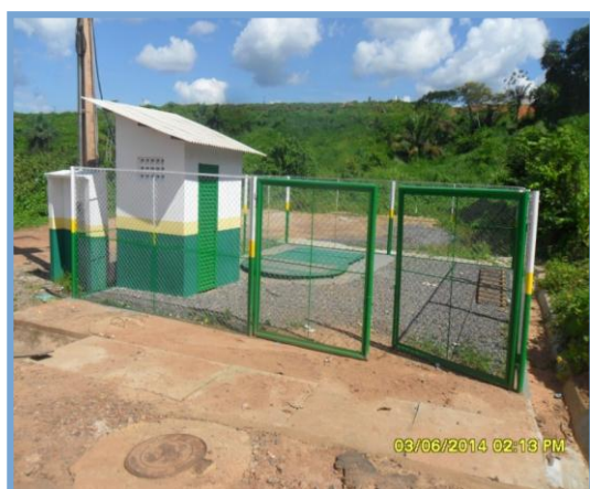
Figura 3-16 – Estação Elevatória de Esgoto integrante do sistema de esgotamento sanitário da Vila de Belo Monte
