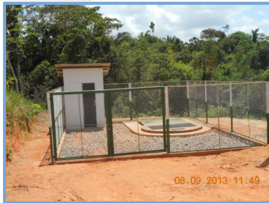
Figura 3-19 – Estação Elevatória de Esgoto integrante do sistema de esgotamento sanitário da Vila de Belo Monte do Pontal
