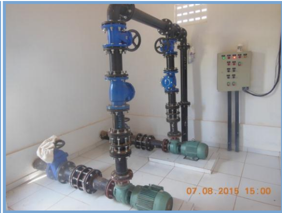
Figura 3-4 – Sistema hidromecânico integrante do sistema de abastecimento de água da Vila de Belo Monte
