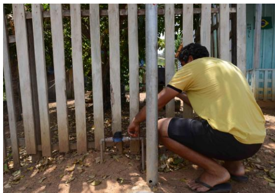
Figura 2-7 – Ponto da rede de distribuição do sistema de abastecimento de água implantado na localidade Vila da Ressaca
