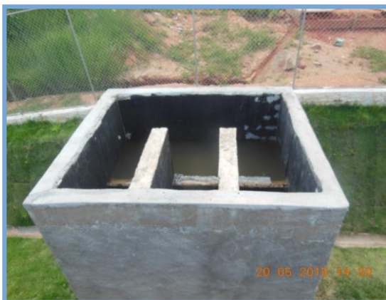
Figura 3-9 – Estação de Tratamento de Água integrante do sistema de abastecimento de água da Vila de Belo Monte do Pontal
