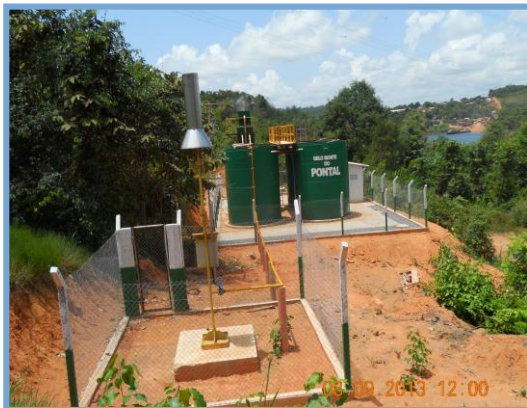
Figura 3-18 – Vista da Estação de Tratamento de Esgoto integrante do sistema de esgotamento sanitário da Vila de Belo Monte do Pontal
