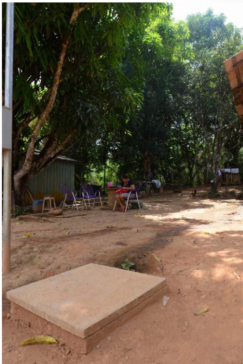
Figura 2-13 – Estrutura componente do sistema de tratamento de esgoto implantado na localidade Vila da Ressaca
