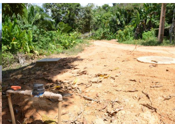
Figura 2-17 – Ponto da rede de distribuição do sistema de abastecimento de água implantado na localidade Garimpo do Galo
