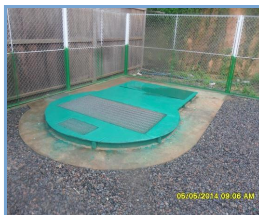
Figura 3-17 – Estação Elevatória de Esgoto integrante do sistema de esgotamento sanitário da Vila de Belo Monte
