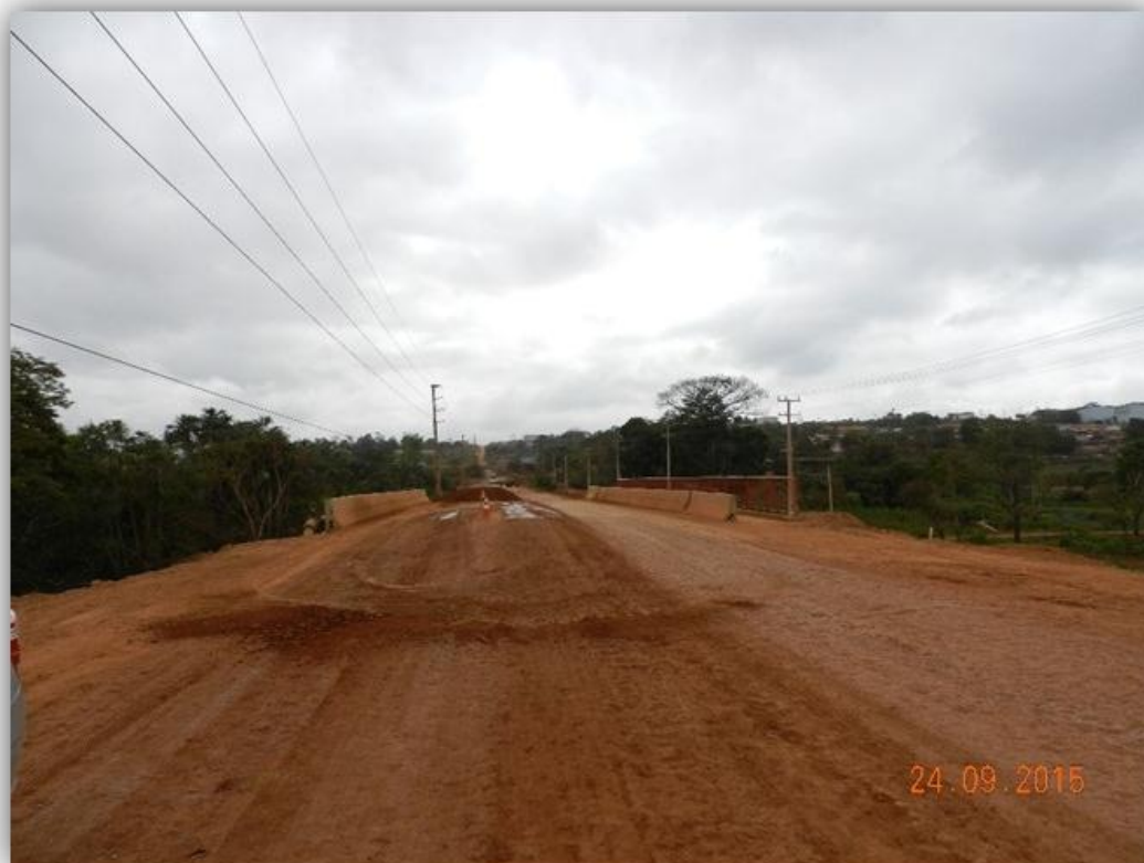
Figura 3-19 Vista do alteamento da via ao encontro da Ponte da Rodovia Transamazônica – Ambé I, sobre o igarapé Ambé, já concluído
