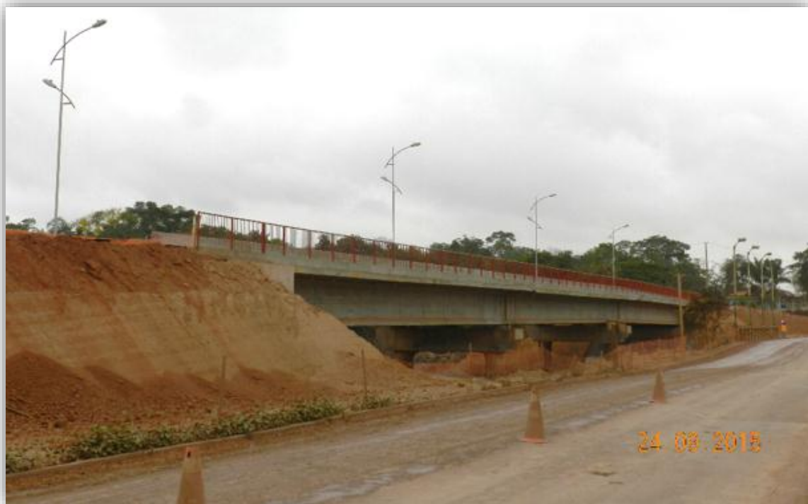
Figura 3-28 Vista do alteamento da via ao encontro da Ponte da Avenida Tancredo Neves, sobre o igarapé Panelas, já concluído
