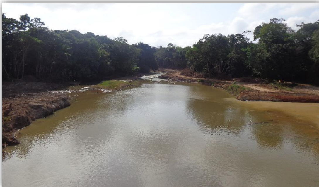
Figura 4-10 Vista da calha do igarapé Panelas, com o reafeiçoamento de suas margens
