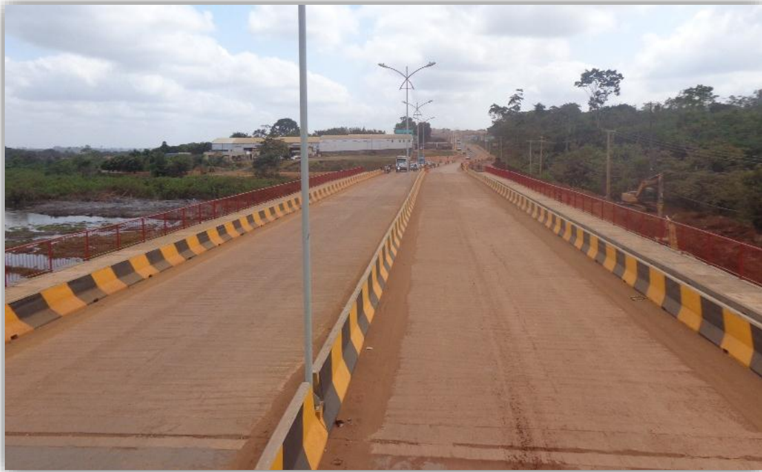
Figura 3-24 Vista da Ponte da Rodovia Ernesto Acioly, sobre o igarapé Ambé, já concluída
