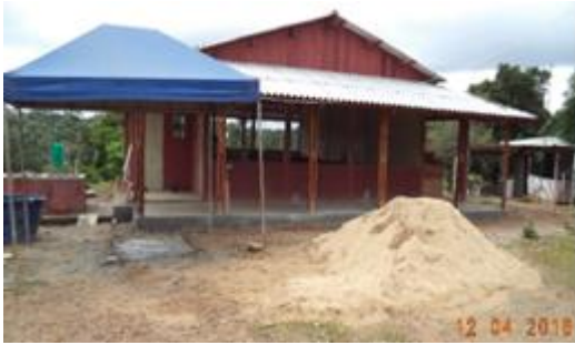
Figura 6 - 32 – Obra: Construção do pátio da casa de farinha – Empresa RJL - PCNI/UHE Belo Monte (abril/2016).
