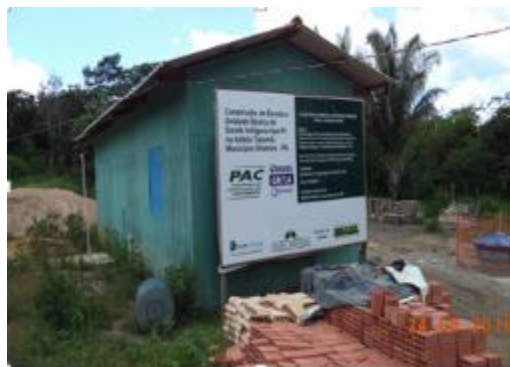
Figura 6 - 93 – Local de armazenamento de material – Empresa LGS - PCNI/UHE Belo Monte (junho/2016).
