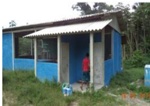
Figura 6 - 57 – Obra: Construção da Casa de Farinha - Empresa W Brasil - aldeia Krãnh - PCNI/UHE Belo Monte (maio/2016).
