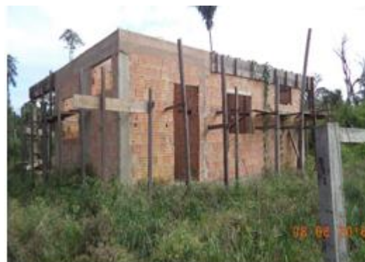
Figura 6 - 63 – Obra: Construção da UBS - Empresa W Brasil - aldeia Py-takô - PCNI/UHE Belo Monte (junho/2016).
