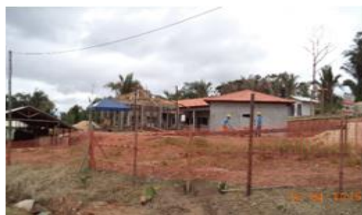
Figura 6 - 37 – Cercado entorno da obra na aldeia Miratu executada pela empresa RJL - PCNI/UHE Belo Monte (abril/2016).
