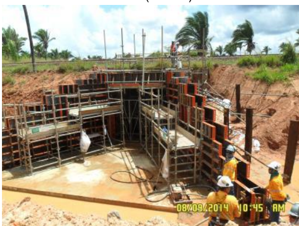
Foto 2-11: Aplicação de fôrmas para aplicação de concreto armado em Passagem de Veículo (PV); (Loc 15).
