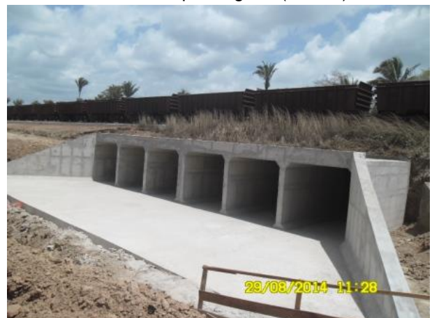
Foto 2-10: BSCC prolongado (Loc 07).
