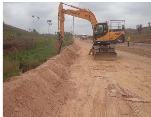
Foto 2-43: Enleiramento lateral ao longo de via de acesso servindo de barreira física ao escoamento pluvial, favorecendo infiltração distribuída e minimizando a formação de caminhos preferenciais (Loc 14).
