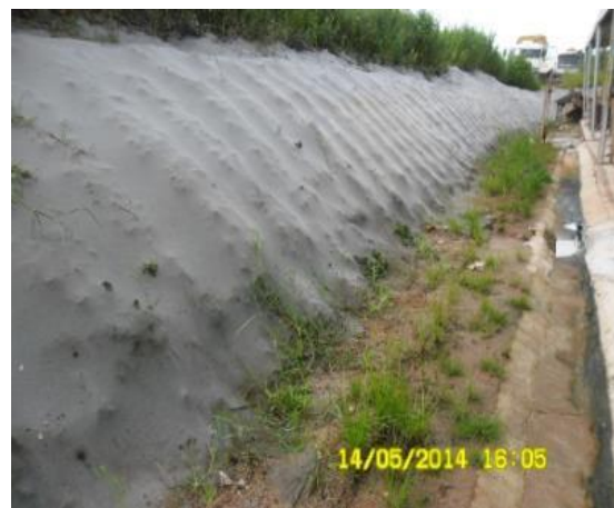
Foto 2-41: Cobrimento de solo exposto do talude através de manta geotêxtil bidim (Loc 14).
