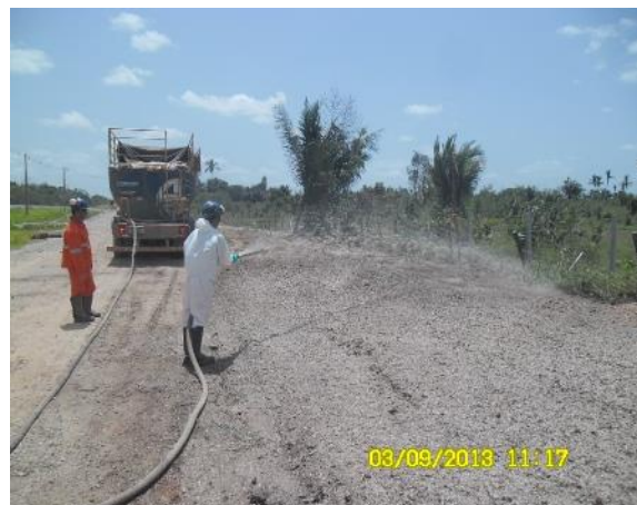
Foto 2-45: Atividade de hidrossemeadura em solo exposto para futura revegetação, servindo ao controle na geração de focos erosivos (Loc 07).
