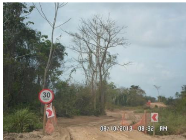
Foto 17-2: Sinalização de velocidade máxima. Locação 07.
