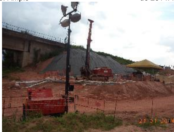
Foto 204: Detalhe da área onde será o Encontro 01 da ponte ferroviária Zutíua, janeiro de 2014. Foto: Amplo
