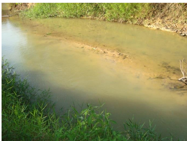
Foto 298: Detalhe do leito assoreado a jusante da travessia. Foto: Ampla
