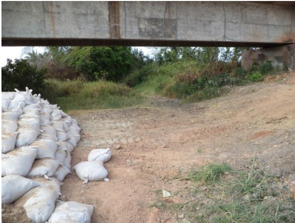
Foto 160: Montante da travessia 77 em outubro de 2013, com existência de sistema de contenção temporária (rip rap). Foto: Amplo
