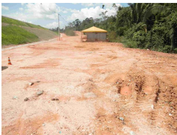
Foto 564: Detalhe das tendas de apoio às obras de duplicação do eixo ferroviário em julho/14. Foto: Amplo
