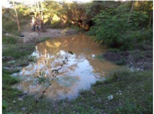
Foto 52: Jusante da travessia 48, em julho/13. Foto: Ampla
