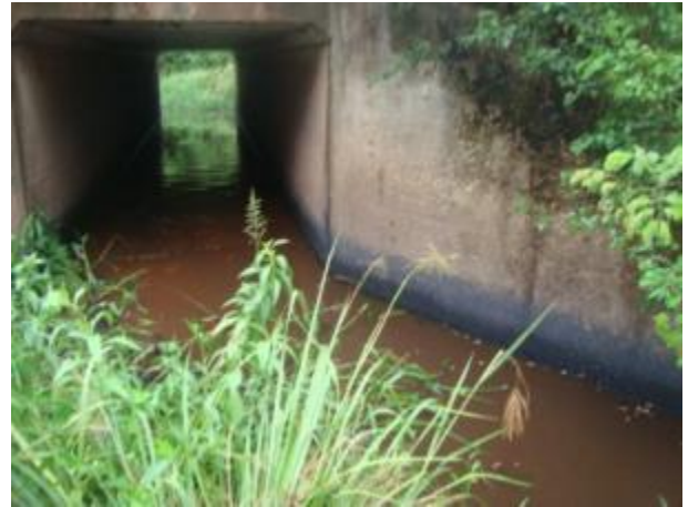
Foto 171: Jusante da travessia 78 em abril/13. Foto: Amplo
