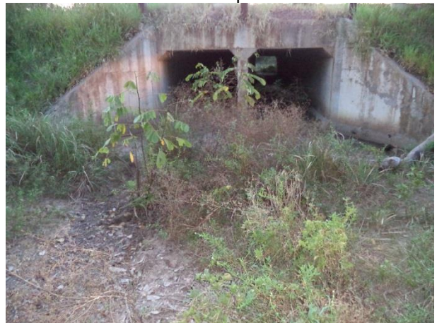
Foto 56: Jusante da travessia 48, em julho/14. Foto: Ampla
