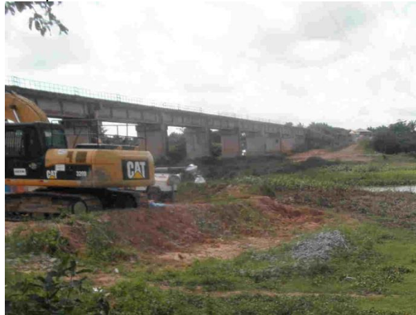
Foto 207: Detalhe das obras a montante da ferrovia em julho de 2014. Foto: Amplo
