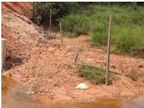
Foto 580: Detalhe do assoreamento na margem a jusante Foto: Ampla
