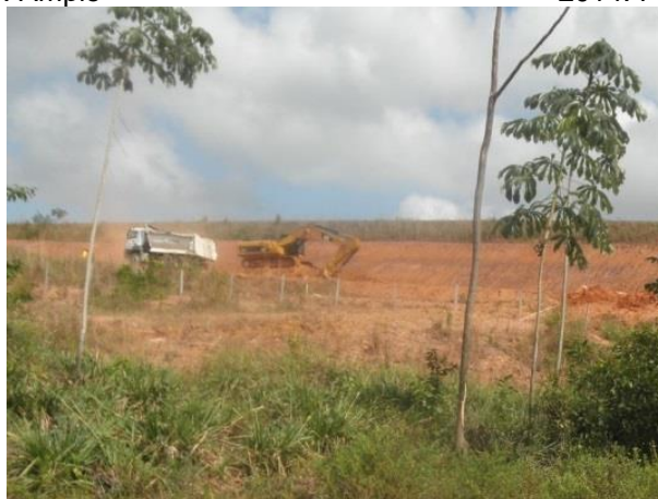
Foto 590: Obras de terraplanagem na área adjacente à travessia 286 em julho de 2014. Foto: Ampla
