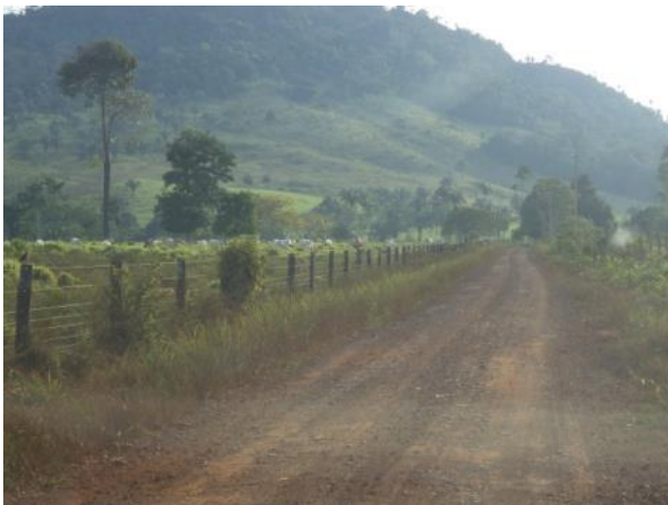
Foto 29: Condições de pavimentação e ausência de sinalização na via de Acesso PA03B, Parauapebas - PA.
