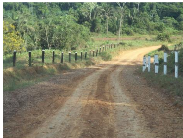
Foto 20: Condições de pavimentação da via de Acesso PA02, Parauapebas - PA.
