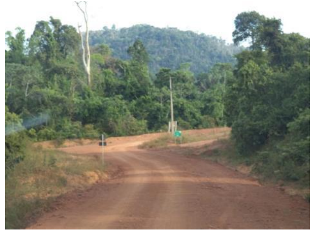
Foto 26: Condição de pavimentação da via de Acesso PA03A, Parauapebas - PA.
