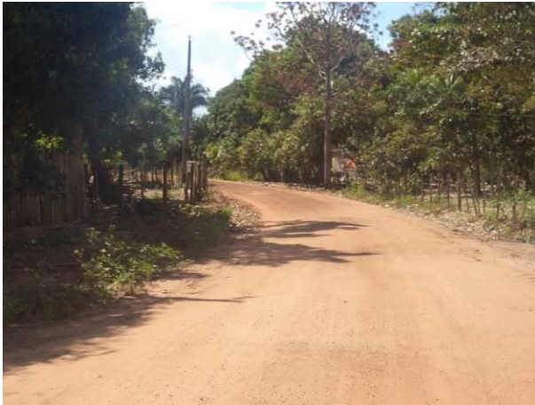
Foto 9: Condições de pavimentação da via na localidade de Atijolado, Arari - MA.
