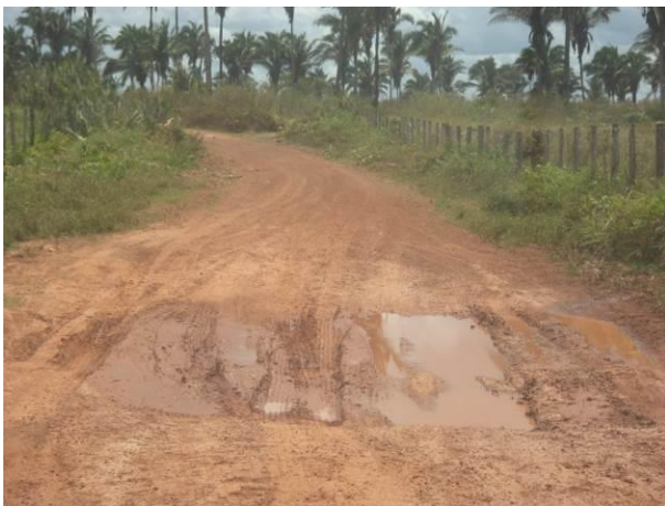
Foto 67: Condições de pavimentação da via de Acesso VM02, Arari - MA.
