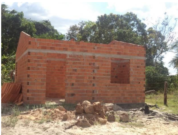
Foto 91: Construção de residência próxima a via de Acesso VM07, Vitória do Mearim, MA.
