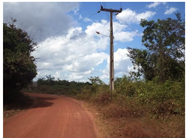
Foto 84: Iluminação pública presente na via de Acesso VM05, Arari - MA.
