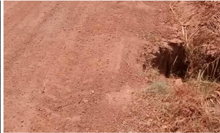
Foto 62: Condição de pavimentação de via de Acesso VM01, Miranda do Norte - MA.
