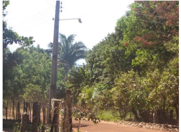
Foto 10: Iluminação pública presente na localidade de Atijolado, Arari - MA.
