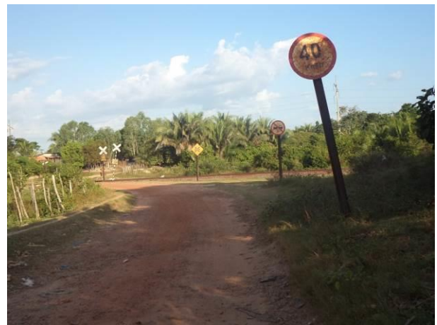
Foto 100: Presença de sinalização na via de Acesso VM09A, Vitória do Mearim, MA.
