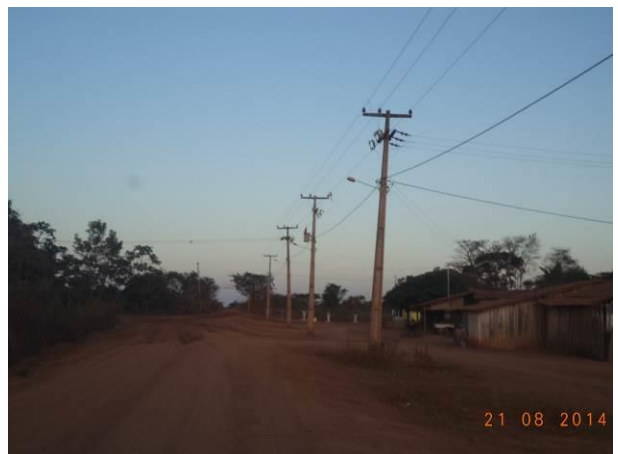
Foto 28: Trecho com iluminação pública na localidade Vila Pau Ferrado, Buriticupu - MA.
