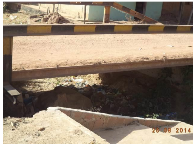
Foto 56: Presença de resíduos sólidos embaixo da ponte, na localidade Vila Pindaré, Buriticupu - MA.
