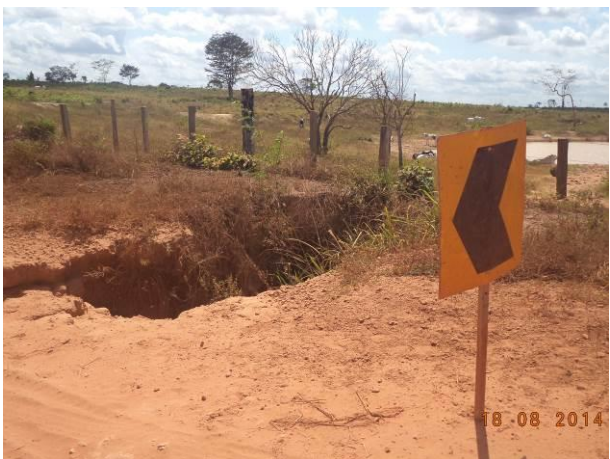
Foto 85: Condições e sinalizações da via de acesso, Buriticupu - MA.
