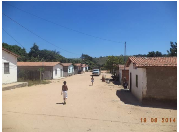
Foto 50: Condições de pavimentação de via da localidade Vila Concórdia, Buriticupu - MA.
