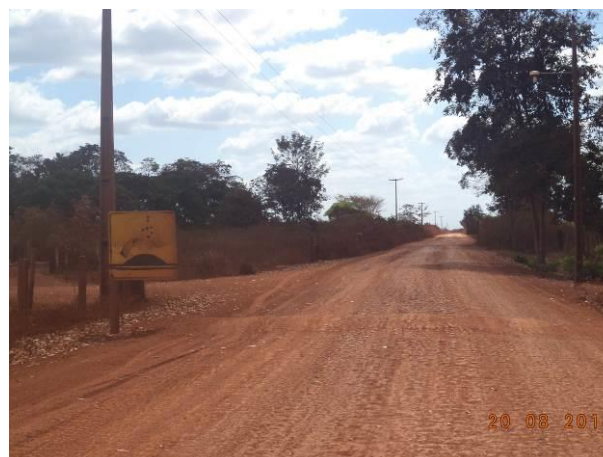
Foto 78: Sinalização improvisada no Acesso BU01, Buriticupu - MA.
