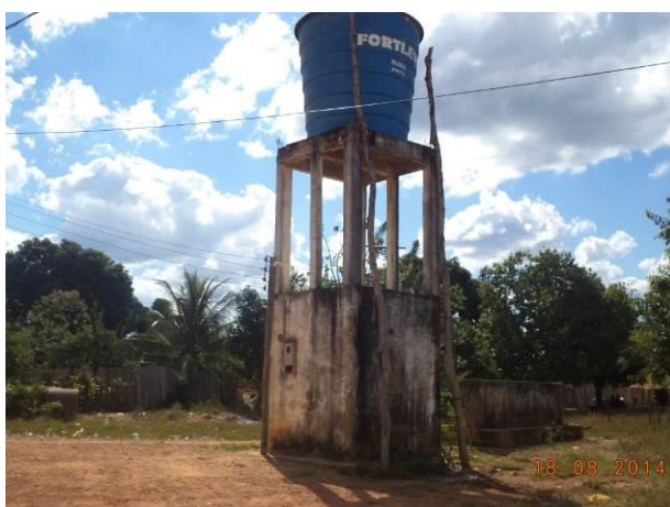
Foto 23: Caixa d'água existente na localidade Vila São João, Buriticupu - MA.
