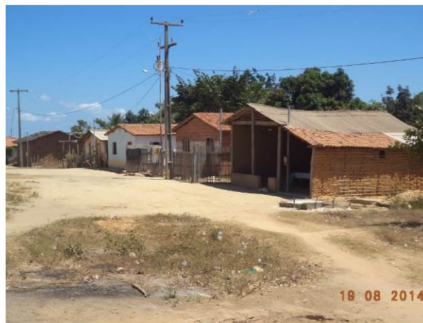
Foto 34: Trecho com iluminação pública na localidade Vila Sequeiro, Buriticupu - MA.
