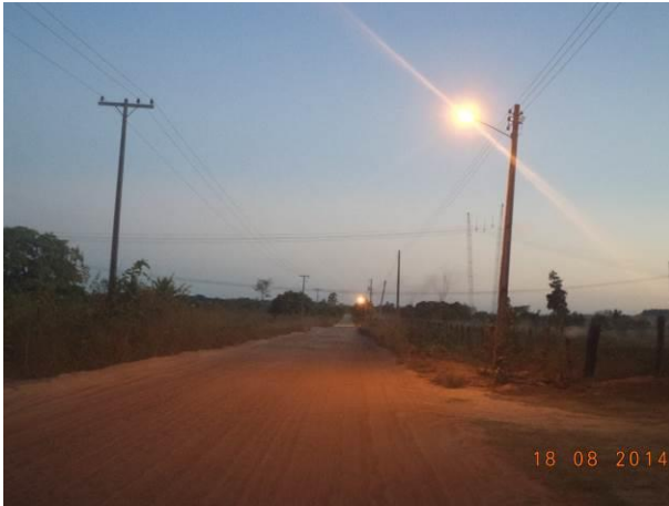
Foto 65: Iluminação Pública na localidade Centro dos Farias, Buriticupu - MA.
