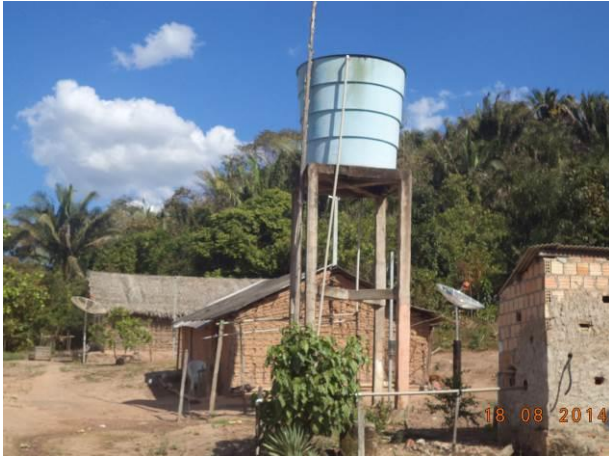
Foto 73: Caixa d'água existente na localidade Vila La Bote, Buriticupu - MA.
