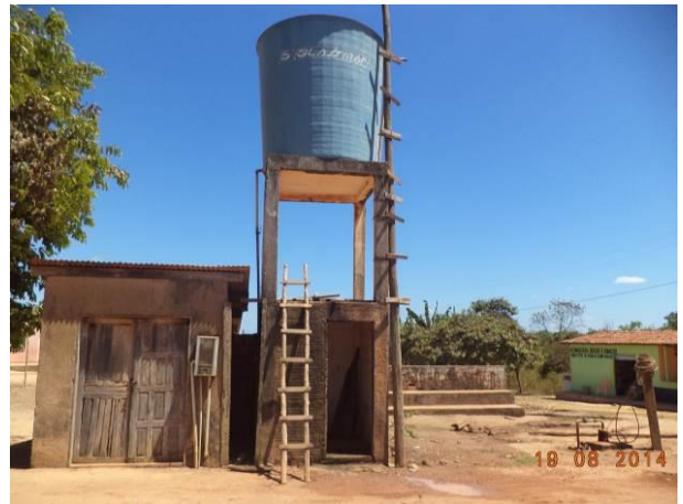
Foto 38: Poço artesiano e reservatório de água existentes na localidade Vila Sequeiro, Buriticupu - MA.
