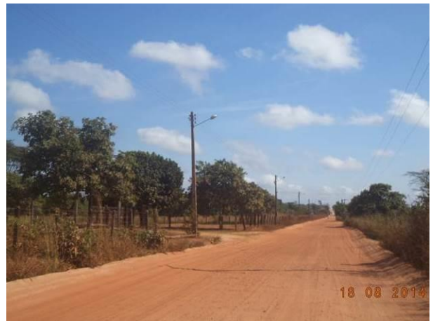
Foto 82: Iluminação Pública presente no Acesso BU02, Buriticupu - MA.
