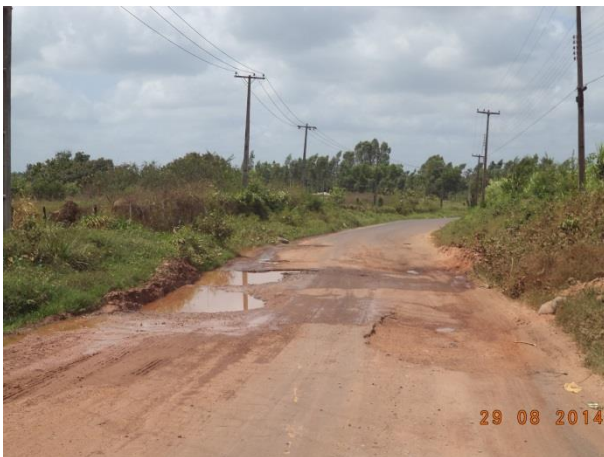
Foto 81: Condições da pavimentação da via de Acesso SI09, Santa Inês - MA.
