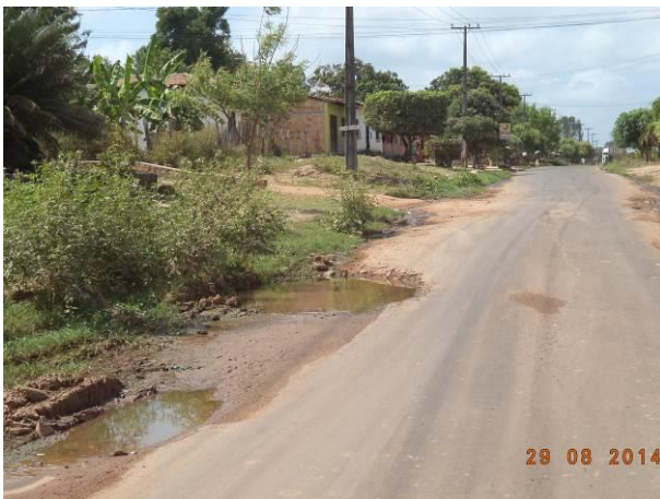
Foto 77: Esgotamento sanitário lançado a céu aberto no Acesso SI09, Santa Inês - MA.
