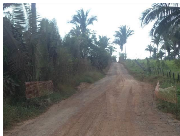
Foto 67: Condições da pavimentação do Acesso SI07, Monção - MA.
