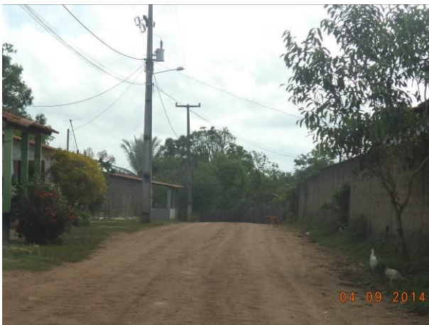
Foto 50: Iluminação pública presente na via de Acesso SI04, Igarapé do Meio - MA.
