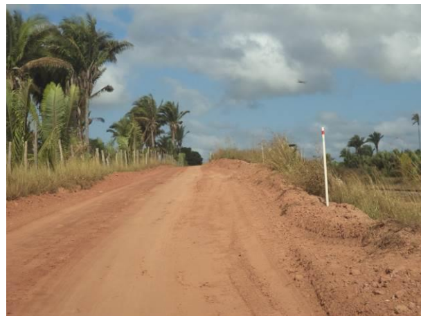
Foto 57: Condições de pavimentação da via de Acesso SI05, Igarapé do Meio - MA.
