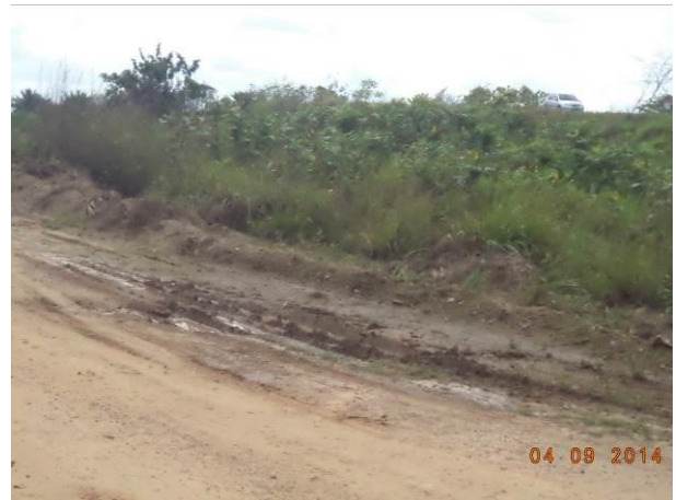
Foto 41: Condições de pavimentação do Acesso SI02, Igarapé do Meio - MA.
