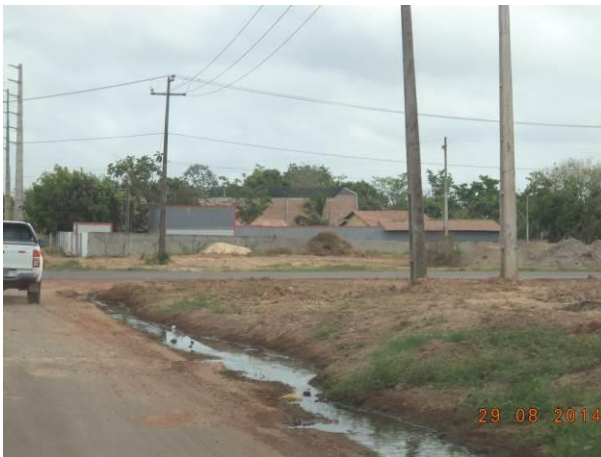
Foto 19: Esgotamento sanitário lançado a céu aberto na localidade Cutia Pelada, Santa Inês - MA.
