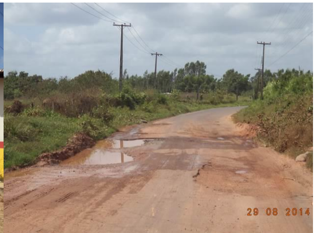
Foto 16: Condição da pavimentação de via da localidade Cutia Pelada, Santa Inês - MA.
