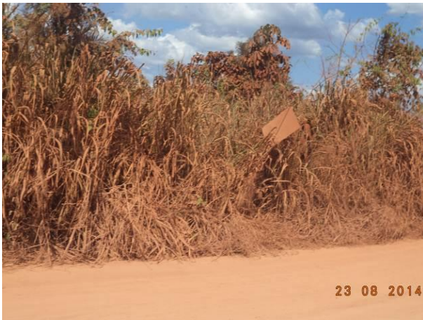
Foto 23: Sinalização parcialmente coberta pela vegetação na via de Acesso BJ01, Bom Jesus das Selvas, MA.
