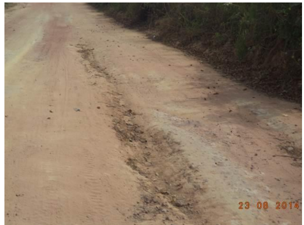
Foto 8: Condições de pavimentação da via de Acesso BJ03, Bom Jesus das Selvas, MA.
