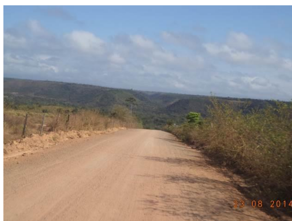
Foto 14: Condições da pavimentação na via de Acesso BJ04, Bom Jesus das Selvas, MA.
