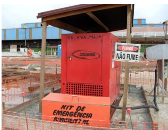
Foto 8: Gerador de energia inserido em bacia de contenção de vazamentos
