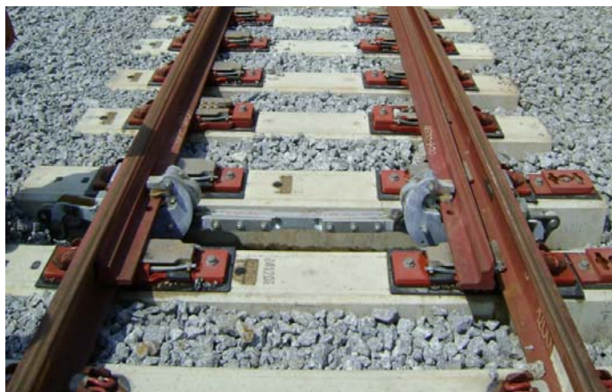
Foto 18: Aparelho de Mudança de Via - AMV em dormente de concreto
