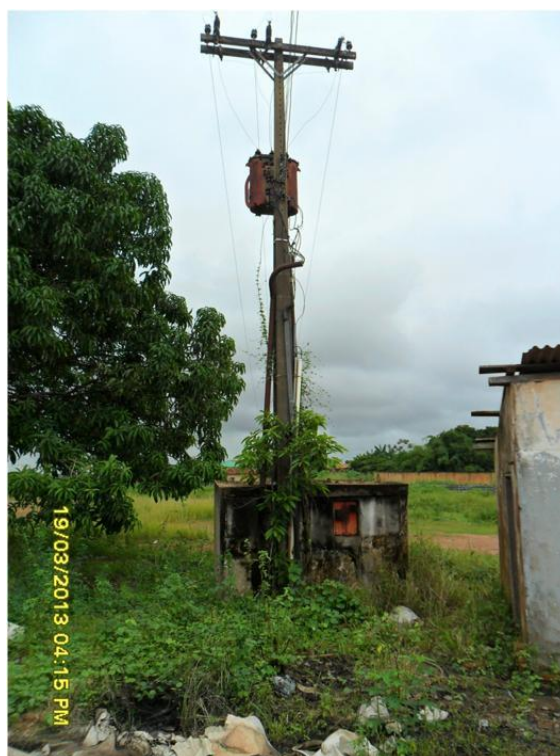
Figura 23. Ponto de fornecimento de energia no Canteiro C1
