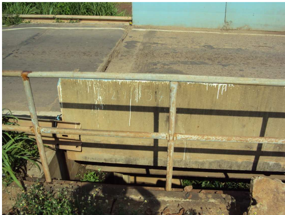
Figura 15 - Junta de dilatação com problema
