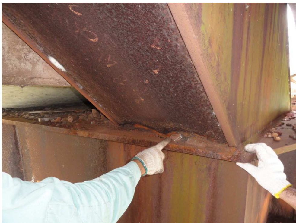
Figura 14 - Solda corroída na ligação do arco.
