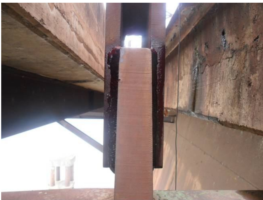
Figura 12 – Vista do olhal de ligação dos tirantes do arco metálico com o caixão metálico
