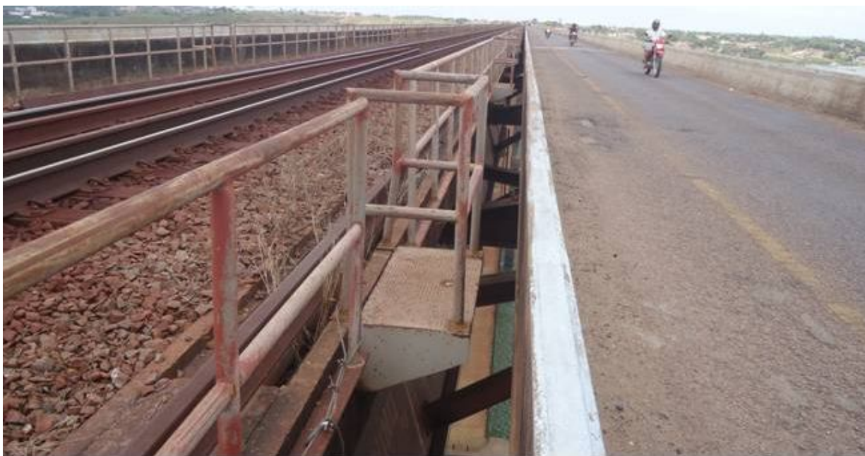
Figura 10 – Foto com vista do tabuleiro ferroviário e rodoviário, no destaque a viga caixão e travessas de suporte rodoviário
