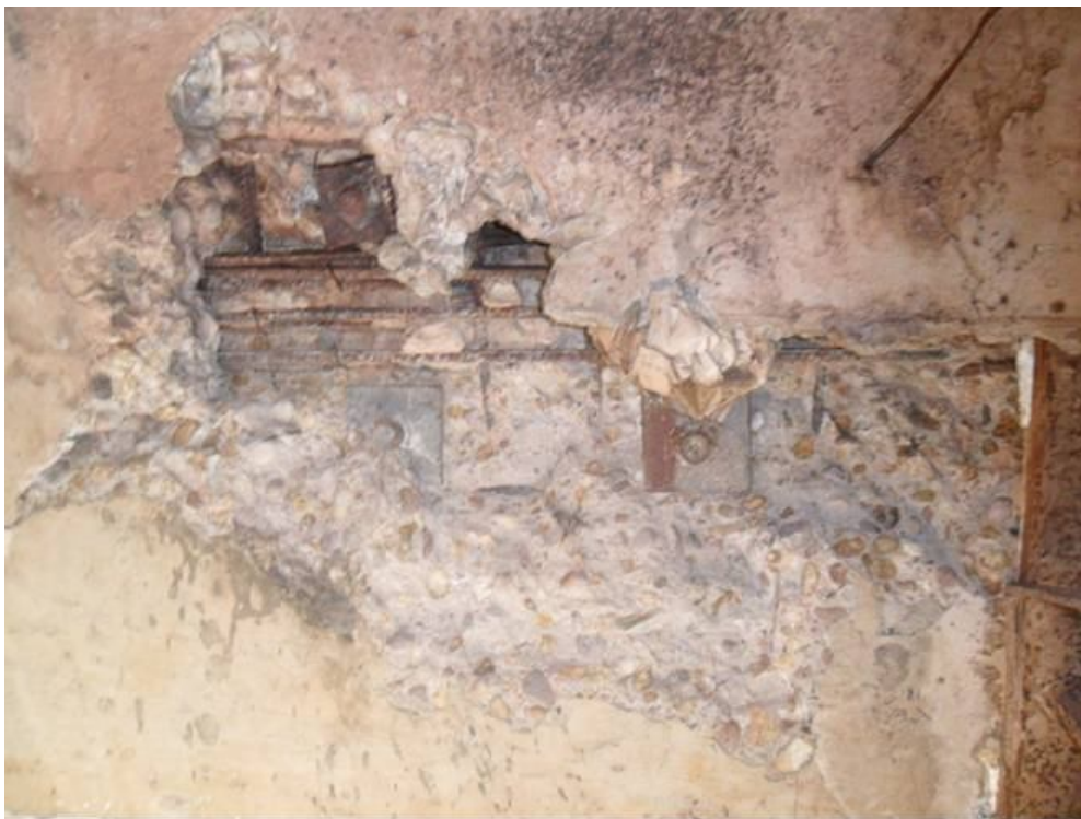
Figura 14 – Foto de patologia na parte inferior do tabuleiro rodoviário
