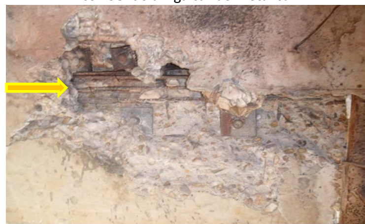
Figura 05. Patologias identificadas na parte inferior do tabuleiro rodoviário
