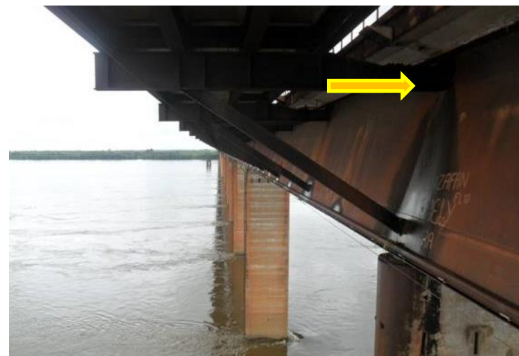
Figura 03. Vazamento do sistema de drenagem, corroendo a viga caixão metálica
