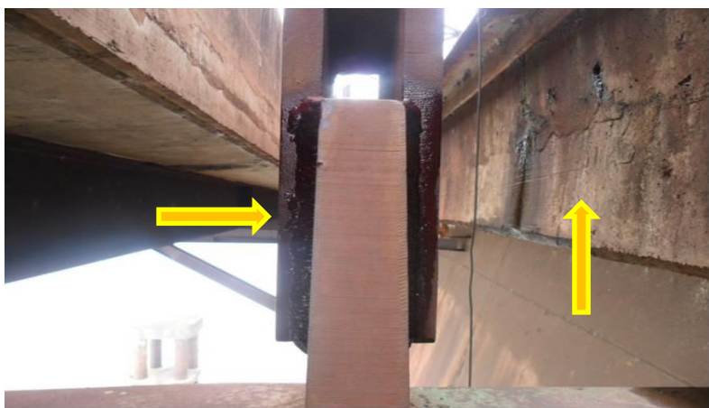
Figura 04. Vista de corrosão no olhal de ligação dos tirantes do arco metálico e patologias no tabuleiro rodoviário
