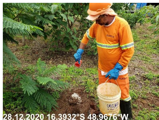
Foto N° 64: Adubação de base para replantio na área 0302, Parque da Cidade, km 0045+900 - 0042+600, Data 28/12/20, Coordenadas Geográficas Decimais 16, 3932 S; 48,9676 W
