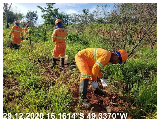
Foto N° 72: Replanteio de mudas na área 0304 Petrolina, km 1495+600 - 1517+000, Data 29/12/20, Coordenadas Geográficas Decimais 16,1614 S; 49,3370W.
