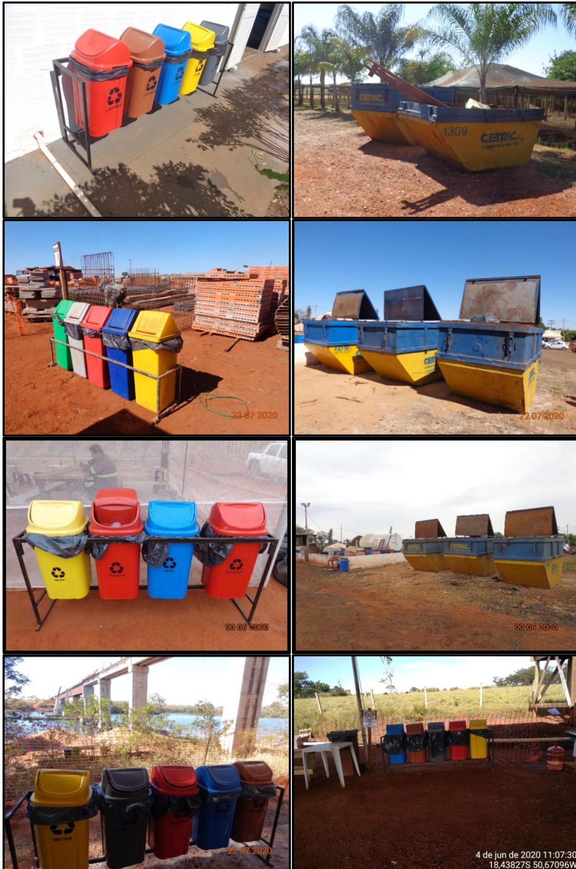
Figura 226 – Registros fotográficos relacionados ao programa de gerenciamento de resíduos evidenciando diversos coletores/caçambas entre as frentes de obra.
