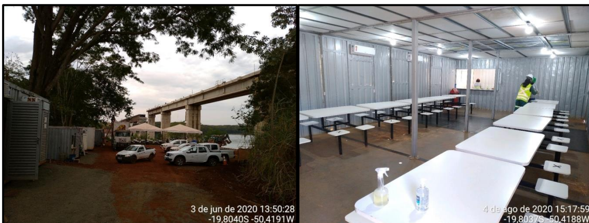
Figura 35 –Canteiro de obras avançado da ponte do Rio Grande: vista geral (esquerda) e refeitório (direita).
