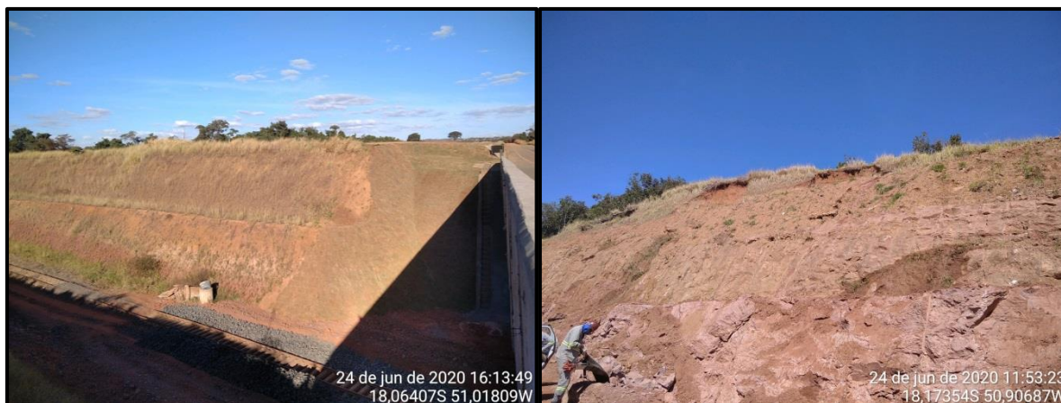
Figura 206 - Registro fotográfico de erosão e assoreamento em talude.
