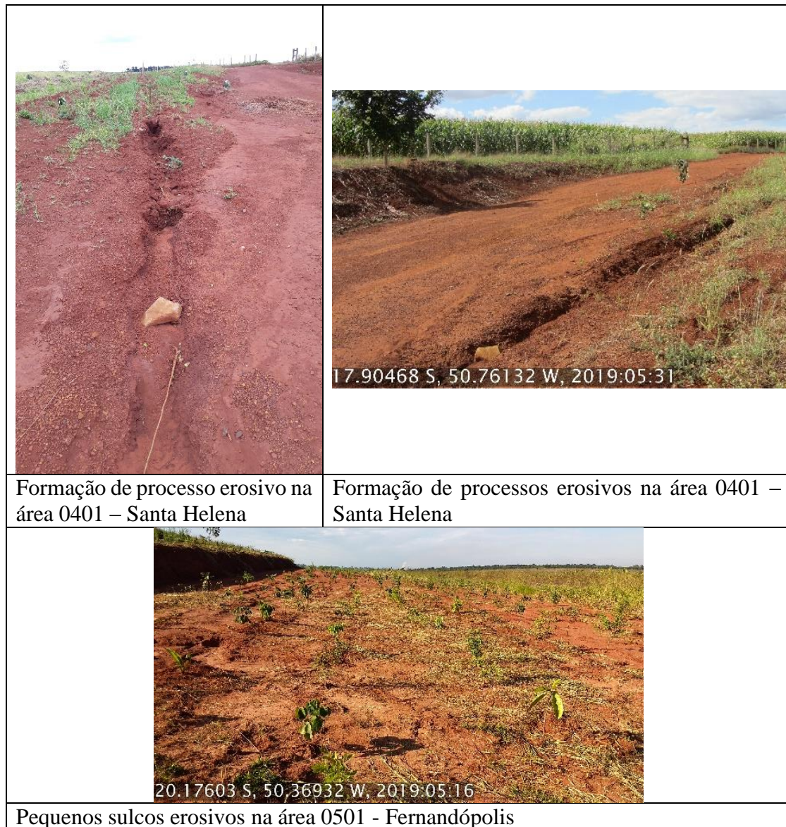
Figura 3.3.5: Formação de processos erosivos nas áreas de plantio
