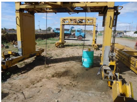
Foto 4-46 Solo contaminado no canteiro avançado da TIISA próximo a estaca 15721.
