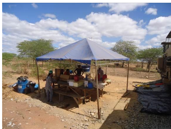
Foto 4-40 Tenda para refeições junto com manutenção de equipamentos na estaca 13513 fora dos padrões da NR 18.
