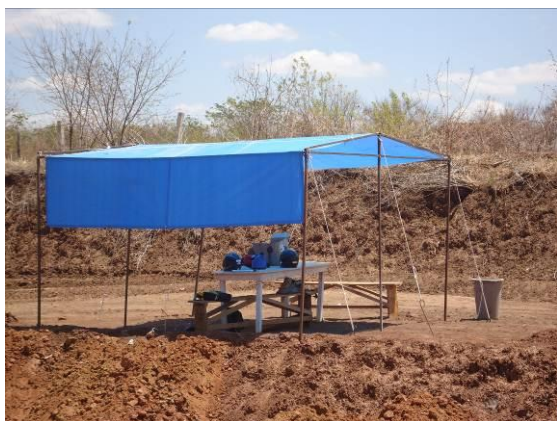
Foto 4-28 Tenda para refeições na estaca 15807 fora dos padrões da NR 18.
