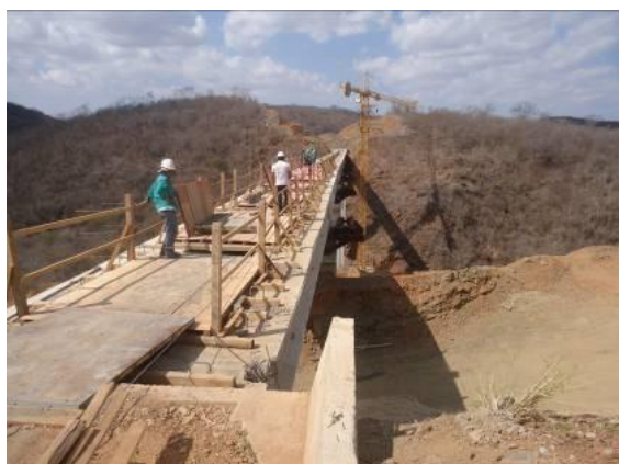
Foto 4-13 Instalação das amarras das vigas sobre os pilares da ponte no riacho Jardim.
