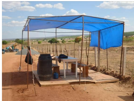
Foto 4-31 Tenda para refeições na estaca 15803 fora dos padrões da NR 18.
