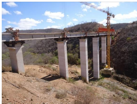
Foto 4-12 Instalação das vigas de ligação na ponte sobre o riacho Jardim, estaca 14395.
