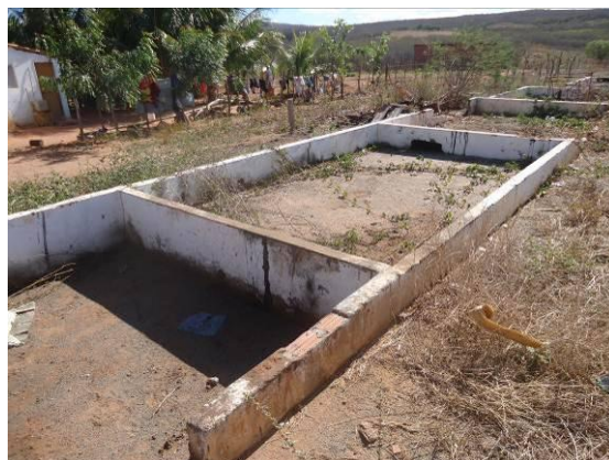
Foto 4-61 SAO com óleo no antigo canteiro de obras da EIT em Café da Linha/CE.
