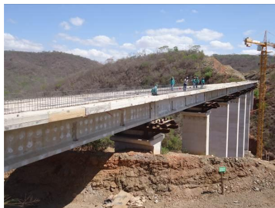
Foto 3-10 Instalação das lajes e montagem das ferragens na ponte sobre o riacho Jardim, Jati-CE. Estaca 14395.
