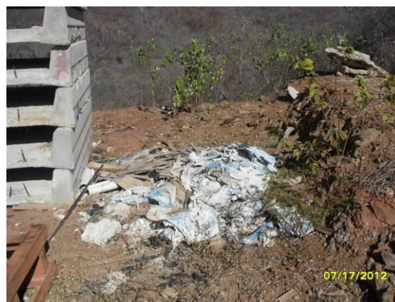
Foto 4-53 Sacos de cimento descartados de forma incorreta próximo a estaca 14386.
