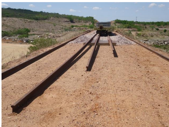
Foto 4-91 Paralisação da superestrutura margem direita do riacho Jardim. Estaca 14292.
