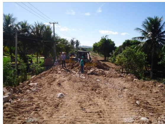
Foto 3-16 Aterro para ligamento entre a rodovia e o viaduto de Porteiras, estaca 15448.
