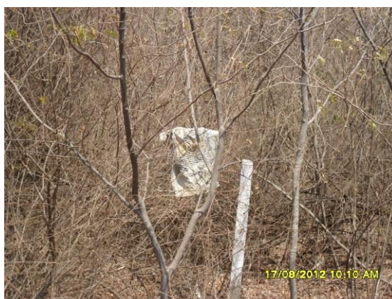
Foto 4-63 Sacos de cimento espalhados pelo solo entre as estacas 16560 a 16578.
