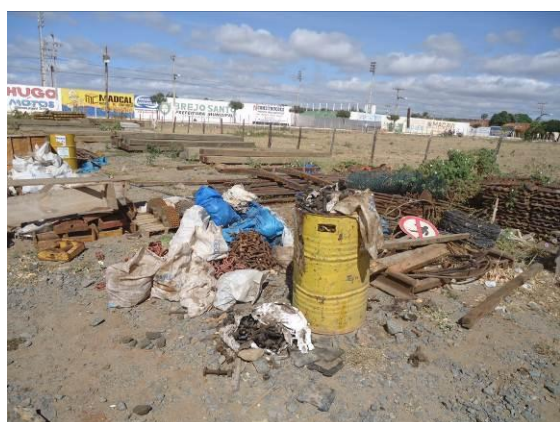
Foto 4-48 Resíduos estocados de forma incorreta no canteiro avançado da TIISA próximo a estaca 15721.
