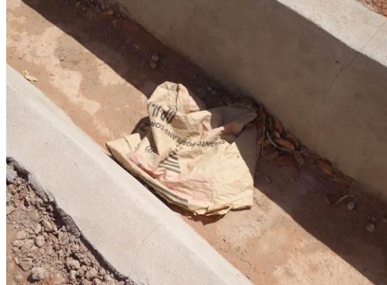
Foto 4-65 Sacos de cimento espalhados pelo solo entre as estacas 16560 a 16578.
