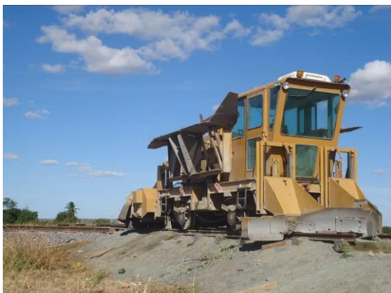
Foto 4-54 Máquina causando contaminação do solo próximo ao canteiro avançado da TIISA, estaca 15721.
