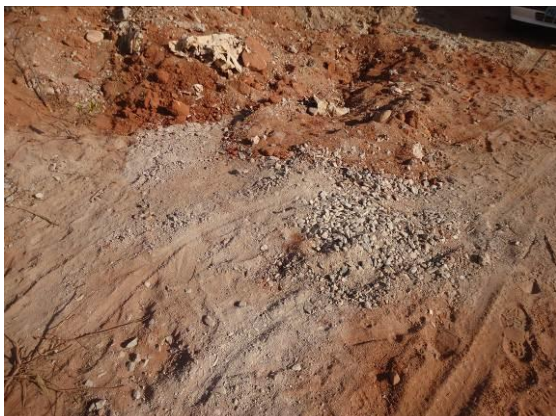
Foto 4-66 Sobras de concreto contaminando o solo na estaca 16562.
