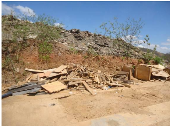
Foto 4-68 Resíduos de madeira espalhadas dentro da faixa de domínio. Estaca 14395.
