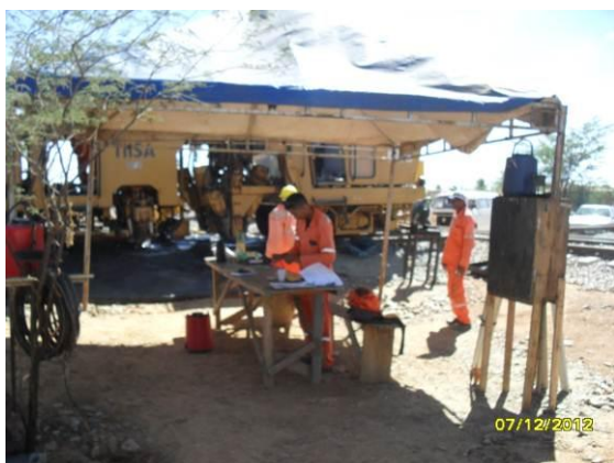
Foto 4-21 Tenda fora dos padrões da NR 18 para refeições, próximo à estaca 13513.
