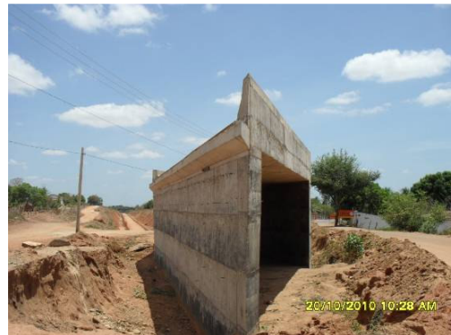
Foto 3-12 - Viaduto rodoviário para Porteiras, faltando a ligação do aterro E- 15435.
