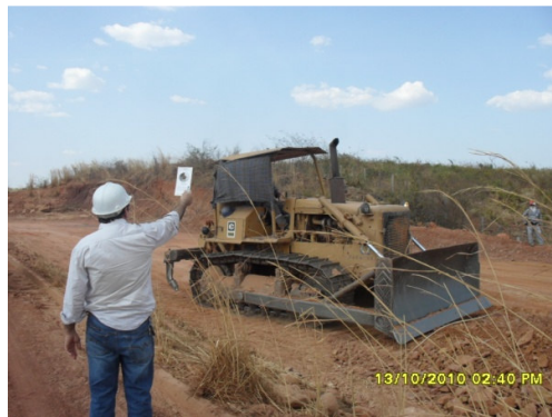
Foto 4-27 – Emissão de fumaça negra (Estaca 1406).
