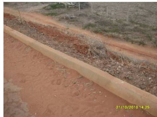
Foto 4-22- Correção da erosão (Estaca 14812).
