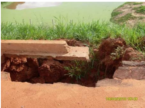
Foto 4-21- Erosão causada pela chuva (Estaca 14812).
