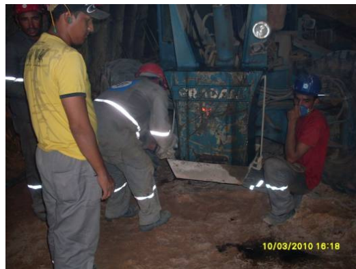
Foto 4. 7 Derramamento de óleo no solo (Estaca 16796).
