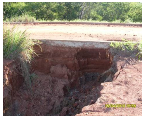
Foto 4. 14– Erosão causada pelas chuvas no talude da ferrovia (Estaca 17147).
