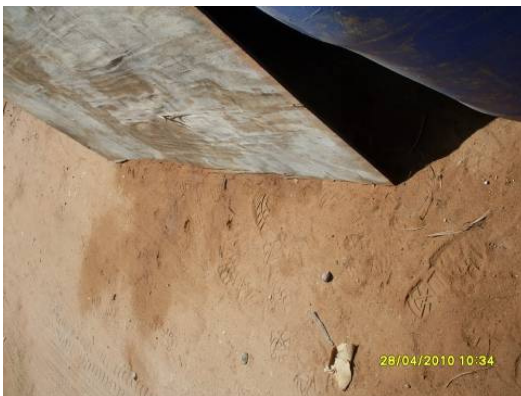
Foto 4. 10– Vazamento de Óleo sem proteção do solo (Estaca 15371).
