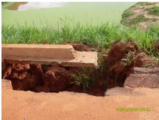
Foto 4. 13– Erosão causada pela chuva (Estaca 14812).
