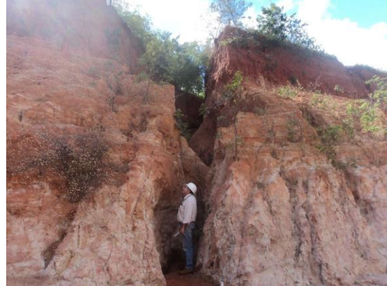
Foto 4.1.244 Talude com sequência de focos erosivos na estaca 16140
