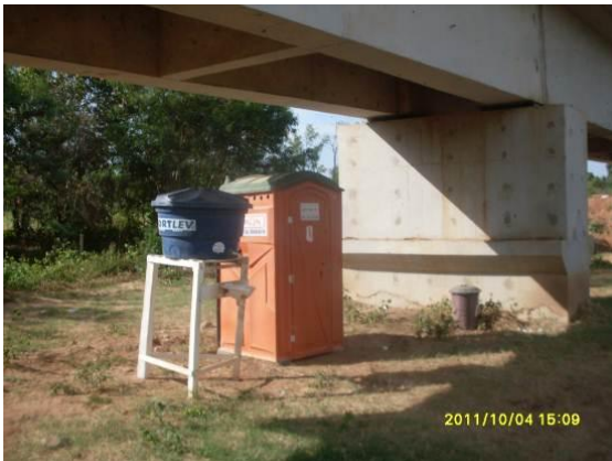
Foto 4.1.45 Instalações e banheiro químico dentro de APP, estaca 15366.
