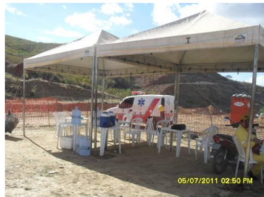
Foto 4.1.29 Instalações de apoio para refeições dos colaboradores da CNO, estaca 14340, não estava de acordo com a NR 18.
