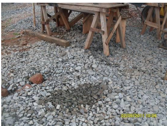
Foto 4.1.86 Ponto de apoio usado como oficina, Brita contaminada no local, estaca 16943.
