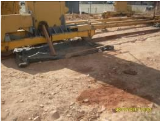
Foto 4.1.157 Solo contaminado por óleo nas proximidades da oficina, no ponto de apoio do Consórcio TIISA/CMC, estaca 15721.
