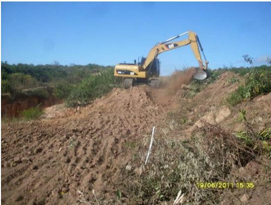
Foto 3.2.7 Máquinas da POLLIAN realizando atividades de retaludamento nas mediações da Vila da Conceição, estaca 16135.
