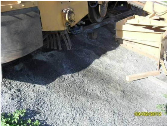
Foto 4.1.189 Máquina em conserto sem bandeja de contenção, estaca 15726.
