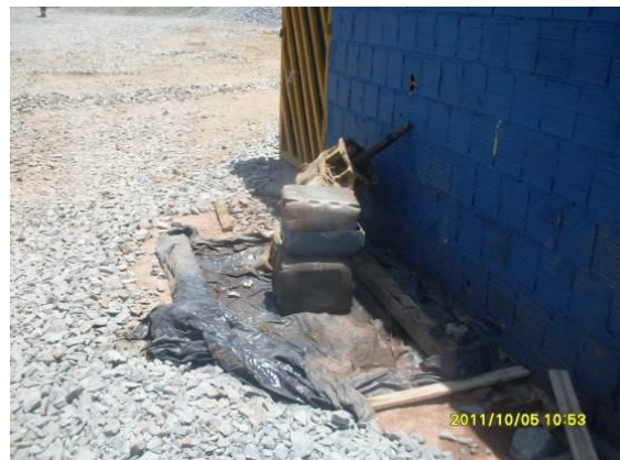
Foto 4.1.160 Plástico e recipiente contaminado por óleo ao céu aberto no talude, estaca 16934.
