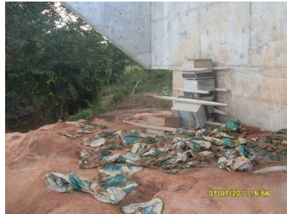
Foto 4.1.112 Embalagens de cimento espalhadas próximo ao riacho Porteiras, estaca 15362.
