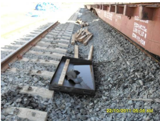
Foto 4.1.169 Máquina com vazamento de óleo, estaca 15714.
