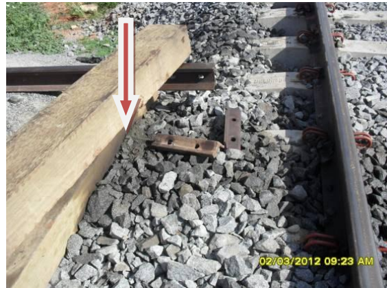
Foto 4.1.186 Brita contaminada por resíduos oleosos, estaca 15710.
