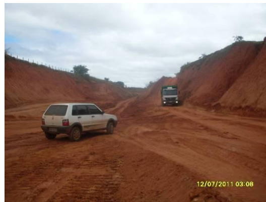
Foto 4.1.64 Faltava sinalização nas vias de acesso entre as estacas 16122 e 16250.
