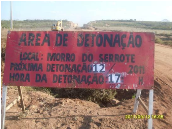
Foto 4.1.73 Placa informando dia e horário da detonação, estaca 15695.
