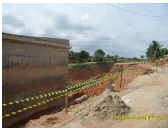
Foto 4.1.81 Sinalização do corte com fita zebraada, estaca 15436.
