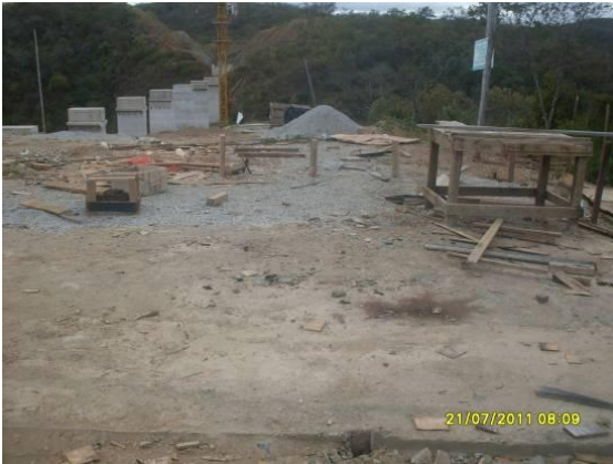
Foto 4.1.113 Resíduos deixados pela construtora EIT próximos ao riacho Jardim, estaca 14406.
