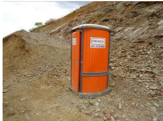
Foto 4.1.59 Falta de higienização nos banheiros químicos, estaca 15434.
