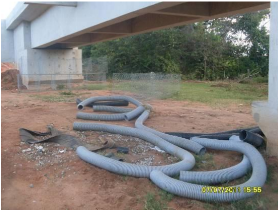
Foto 4.1.111 Tubos usados na drenagem, deixados na obra pela construtora EIT, próximo ao riacho Porteiras, estaca 15362.
