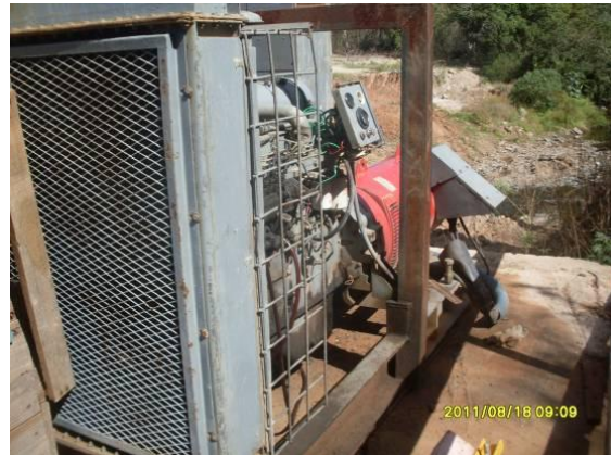
Foto 4.1.122 Gerador que estava dentro de APP sem bandeja de contenção, estaca 14406.
