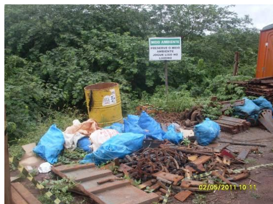
Foto 4.1.87 Resíduos (sucatas e madeiras) gerados da obra acondicionados irregularmente, estaca 16943.
