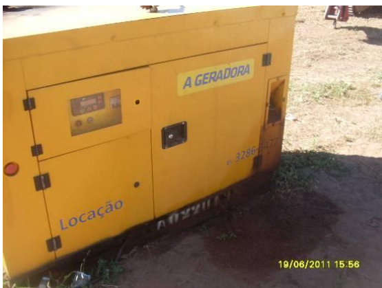
Foto 4.1.101 Máquina geradora de energia, com vazamento de combustível contaminado o solo, estaca 15713.
