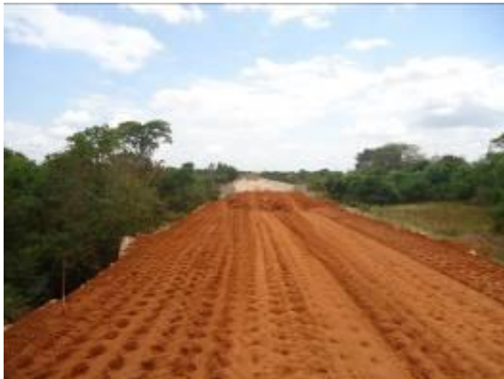
Foto 3.2.17 Ligação de lastro com a ponte sobre o Riacho de Porteira, estaca 15365.
