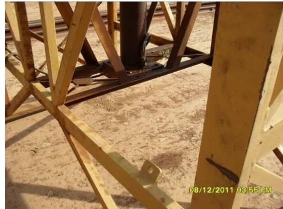
Foto 4.1.176 Máquina com vazamento contaminando o solo, estaca 14686.
