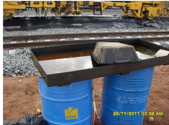
Foto 4.1.182 Bandeja de contenção deixada a céu aberto, com óleo proveniente de manutenção de máquinas, estaca 15702.
