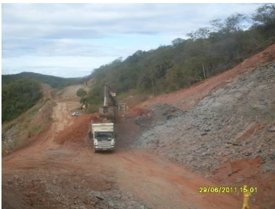
Foto 3.2.3 Máquinas da CNO realizando atividades de retirada do solo proveniente do retaludamento, estaca 14370.
