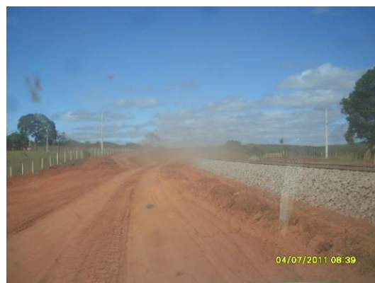
Foto 4.1.224 Falta de umectação da via de acesso, estaca 16233.
