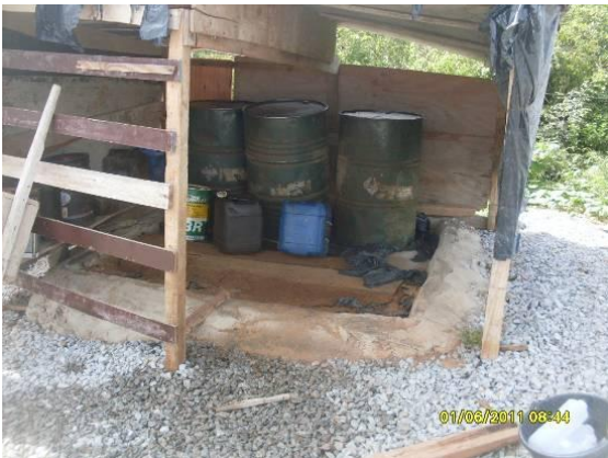
Foto 4.1.93 Contaminação do solo no momento de abastecimento das máquinas, estaca 14403.
