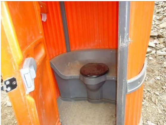
Foto 4.1.58 Falta de higienização nos banheiros químicos, estaca 13326.
