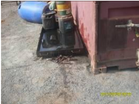
Foto 4.1.133 Armazenamento de óleo de forma inadequada. Ponto de apoio do Consórcio TIISA/CMC, estaca 16182.
