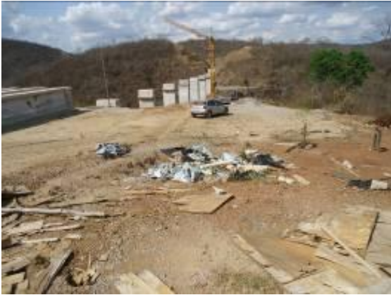
Foto 4.1.155 Restos de madeira e outros resíduos sólidos espalhados próximo ao riacho Jardim, estaca 14406.
