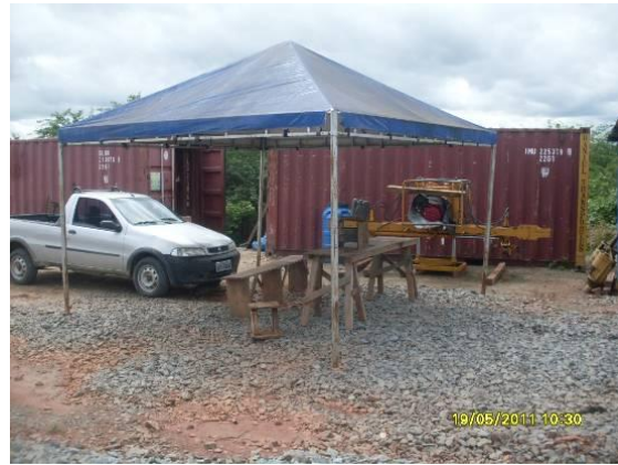
Foto 4.1.20 Ponto de apoio removido para fora da APP, estaca 16935.
