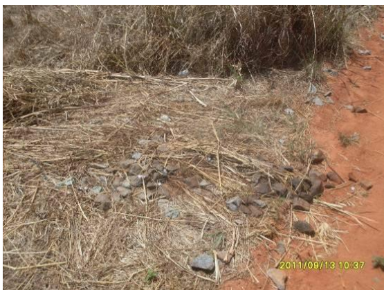
Foto 4.1.143 Óleo derramado no talude contaminando o solo, estaca 16927.
