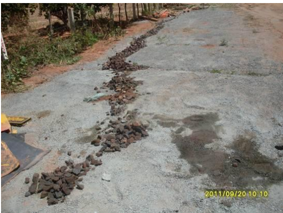
Foto 4.1.147 Brita contaminada espalhada e sinais de óleo derramado no solo, estaca 16182.
