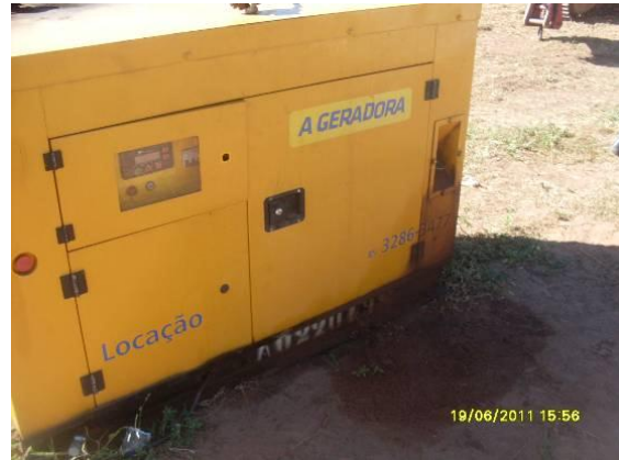
Foto 4.1.92 Máquina geradora de energia, com vazamento de combustível contaminado o solo, estaca 15713.
