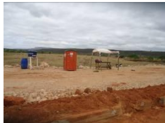
Foto 4.1.48 Instalações de apoio precárias para refeições dos colaboradores da POLLIAN, estaca 15593.
