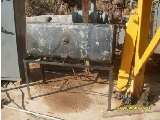
Foto 4.1.145 Gerador que estava dentro de APP,(riacho Jardim) sem bandeja de contenção, estaca 14406.
