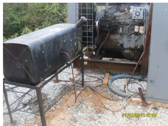
Foto 4.1.96 Gerador de energia fora da baia, estaca 14404.
