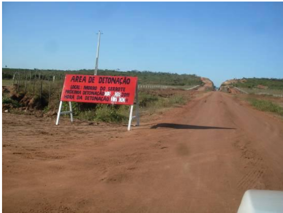
Foto 4.1.67 Placa informando dia e horário da detonação, estaca 15695.
