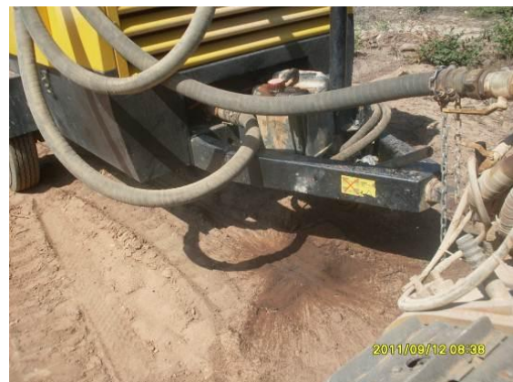
Foto 4.1.144 Gerador com vazamento no mangote sem bandeja de contenção, estaca 15674.
