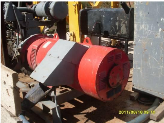
Foto 4.1.123 Gerador que estava dentro de APP sem bandeja de contenção, estaca 14406.
