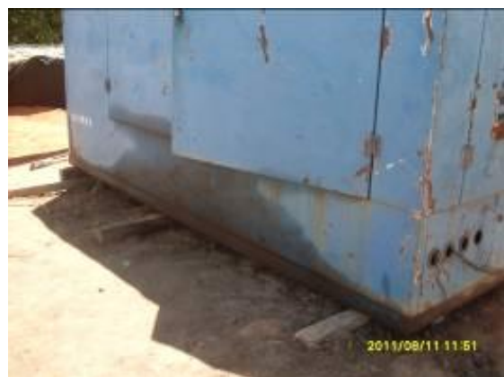
Foto 4.1.120 Gerador que estava dentro de APP sem bandeja, estaca 15362.
