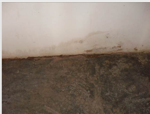
Foto 3 - Rachaduras no piso, Brejo Santo, setembro de 2011.
