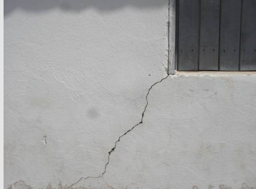
Foto 2 - Rachaduras nas paredes, Brejo Santo, setembro de 2011.
