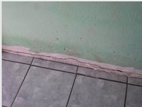
Foto 3 - Rachaduras no piso, Brejo Santo, setembro de 2011.
