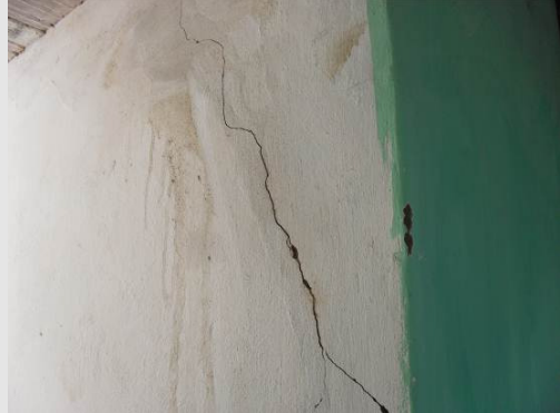
Foto 2 - Rachaduras nas paredes, Brejo Santo, setembro de 2011.
