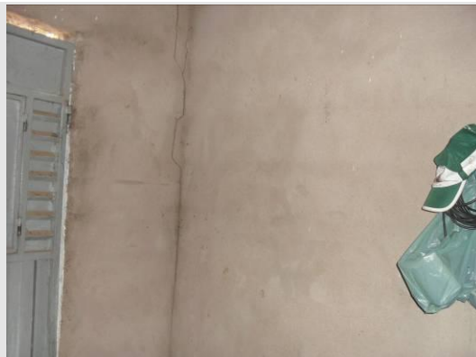
Foto 2 – Rachaduras nas paredes, Brejo Santo/CE, outubro de 2011.
