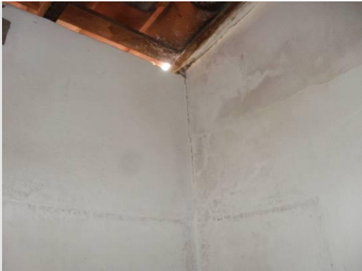
Foto 3 – Rachaduras nas paredes, Brejo Santo/CE, outubro de 2011.
