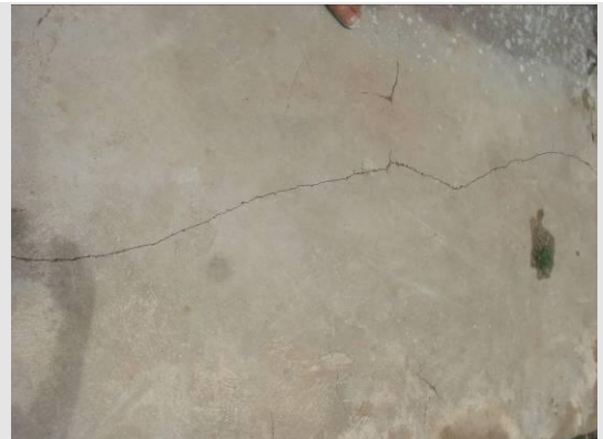
Foto 4 – Rachaduras no piso, Brejo Santo/CE, outubro de 2011.
