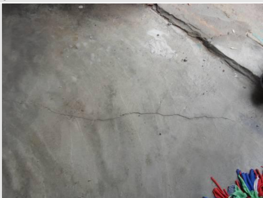
FOTO 3 - Rachaduras no piso, Brejo Santo, outubro de 2011.
