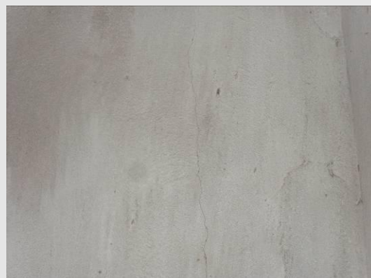
Foto 4 - "Rachaduras nas paredes", Brejo Santo, outubro de 2011.
