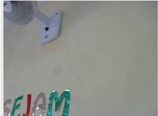
Foto 4 – Rachaduras nas paredes, Brejo Santo/CE, outubro de 2011.
