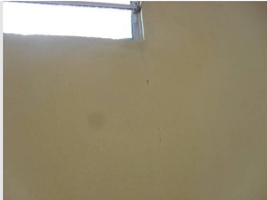
Foto 3- Rachaduras nas paredes, Brejo Santo/CE, outubro de 2011.
