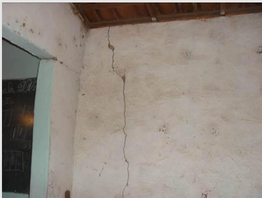
Foto 3 - Rachaduras nas paredes, Brejo Santo/CE, novembro de 2011.
