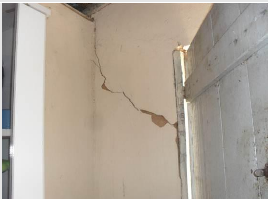
Foto 3 - Rachadura nas paredes, Porteiras/CE, novembro de 2011.
