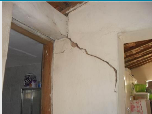
Foto 2 - Rachadura nas paredes, Porteiras/CE, novembro de 2011.
