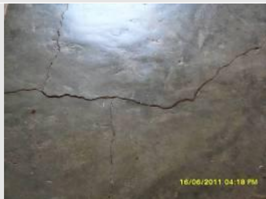
Foto 4 – Rachadura no piso da sala
