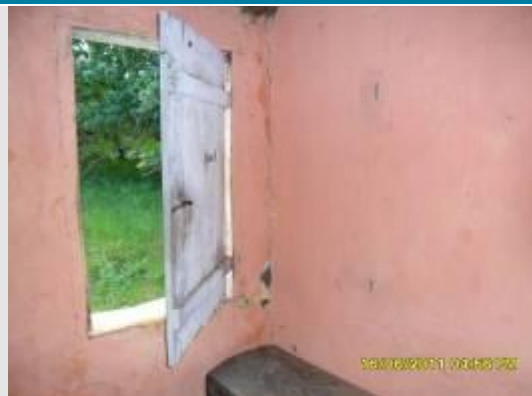
Foto 2 – Rachadura na parede da sala
