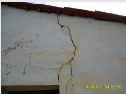
Foto 3 – Rachadura na parede de fora da cozinha
