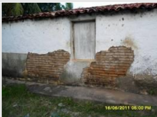
Foto 3 – Reboco que caiu com os abalos
