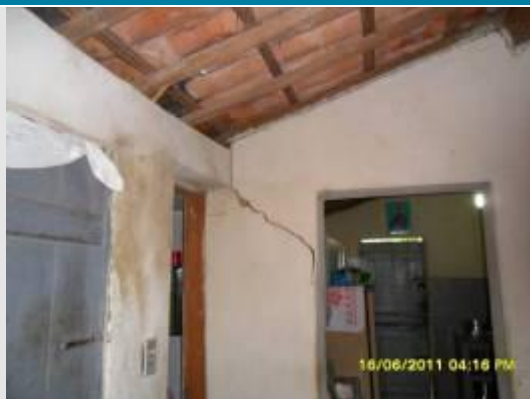
Foto 2 – Rachadura na parede da cozinha
