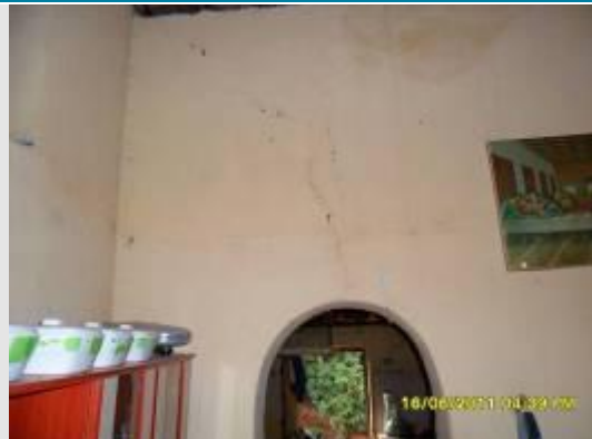
Foto 2 – Rachadura na parede da sala
