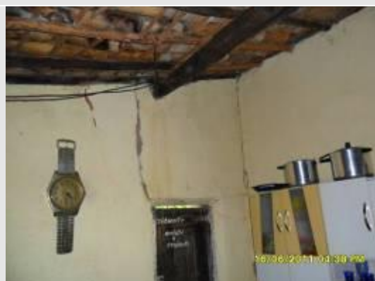
Foto 4 – Rachadura na parede de dentro da cozinha
