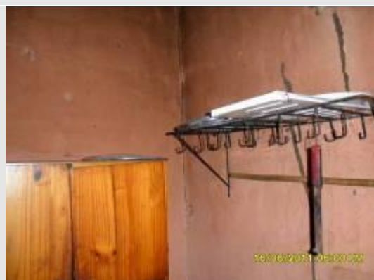
Foto 4 – Rachadura na parede da cozinha
