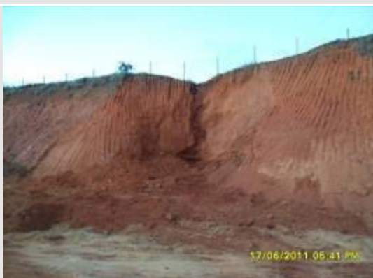
Foto 3 – Erosão no corte onde caíram animais
