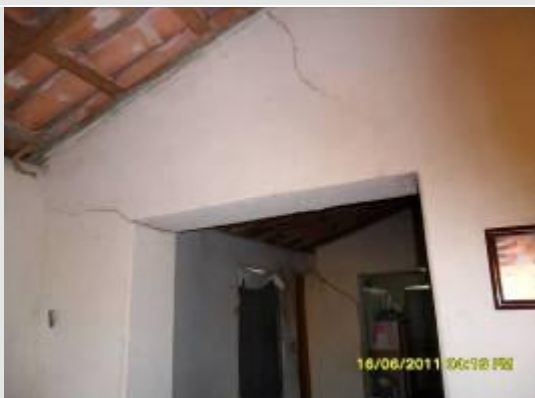
Foto 3 – Rachadura na parede da sala
