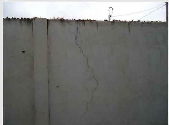
Foto 2 - Rachaduras no muro da propriedade.
