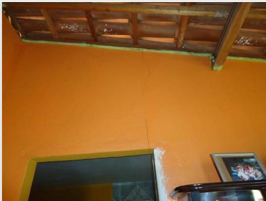
Foto 3- Rachaduras nas paredes
