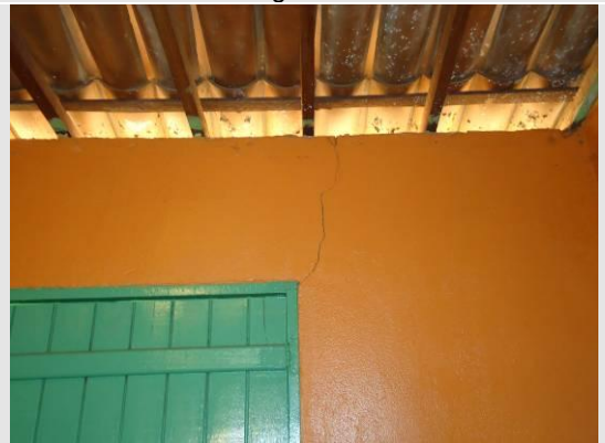
Foto 4- Rachaduras nas paredes
