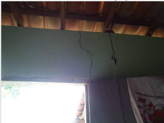
Foto 3- Rachaduras nas paredes
