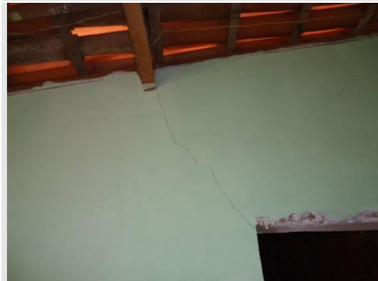
Foto 4 – Rachaduras nas paredes.
