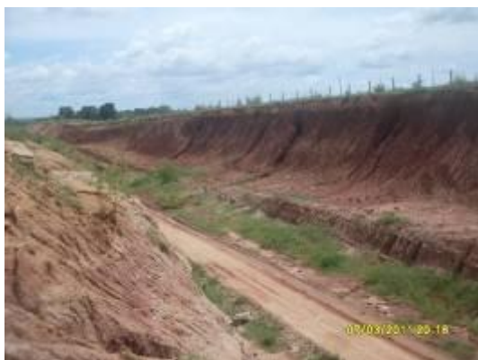
Foto 4-117 Erosões no talude de corte, estacas 14074 a 14082.
