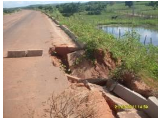
Foto 4-122 Erosões no talude de aterro, estaca 16061.
