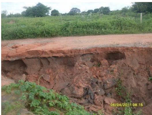
Foto 4-135 Erosão no talude corte da ferrovia, estaca 15438.
