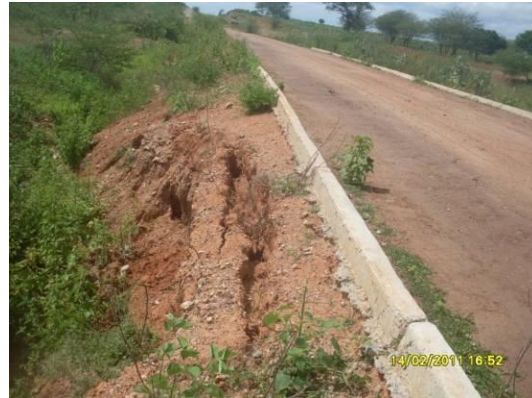
Foto 4-98 Erosão no talude de corte, o mesmo atingiu o meio fio e causou fissuras no lastro da ferrovia estaca 13372.
