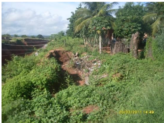
Foto 4-109 Erosão no talude de corte, já citado em relatório anterior, estacas 15433.
