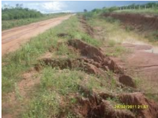
Foto 4-113 Sequências de erosões no talude de aterro, estaca 13632.
