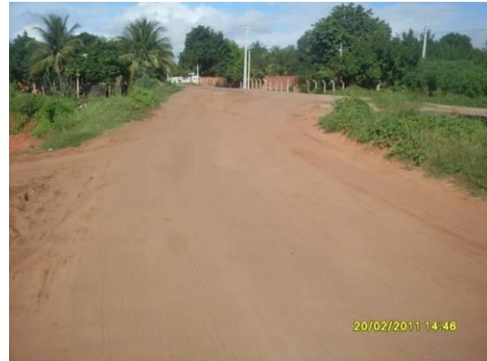
Foto 4-41 Desvio da passagem de Porteiras, continua com a sinalização precária, estaca 15436.
