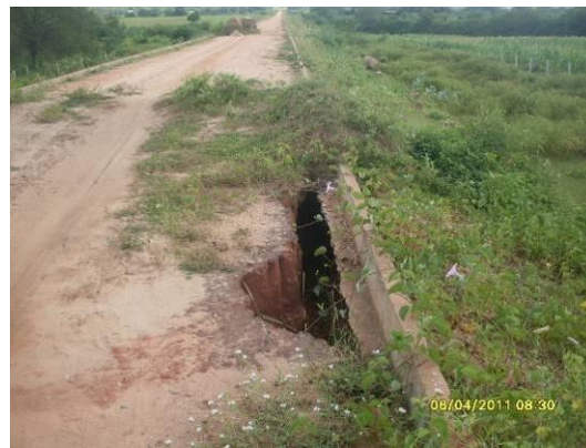
Foto 4-134 Erosão no lastro da ferrovia, estacas 15547 a 15580.
