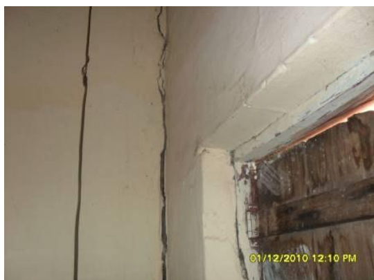
Foto 4-151: Rachaduras em residência indiretamente atingida no Sítio Boqueirão em dezembro de 2010, Abaiara/CE.
