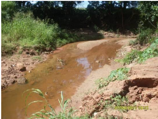
Foto 4-139 Assoreamento no riacho Boqueirão estaca 16433.
