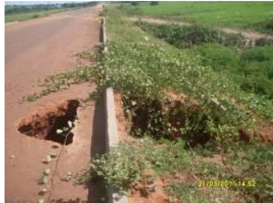
Foto 4-120 Erosões no talude de aterro, estaca 15961.
