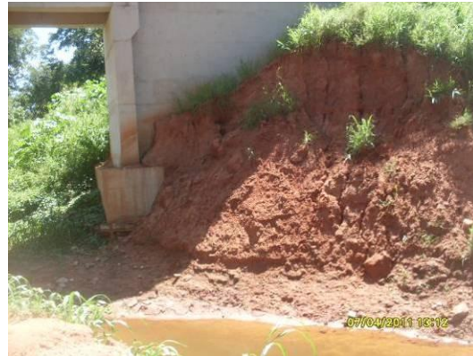
Foto 4-138 Escorregamento do talude no riacho Boqueirão estaca 16433.
