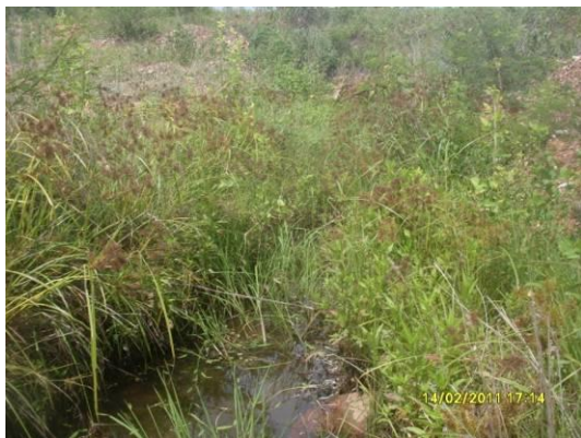
Foto 4-105 Bueiro obstruído estacas 13313.
