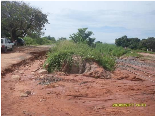
Foto 4-125 Erosão no talude de corte Estaca 16941.
