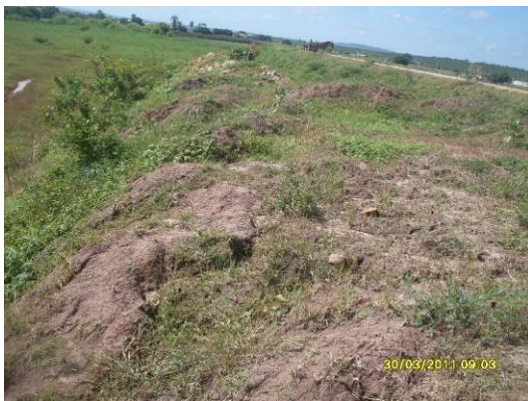
Foto 4-129 Erosão no talude de aterro, estaca 15746-15749.
