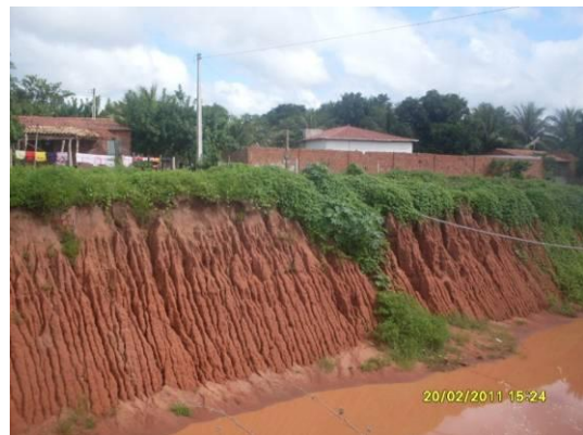
Foto 4-110 Sequência de erosões no talude de corte, já citado em relatório anterior, estacas 15366 á 15433.
