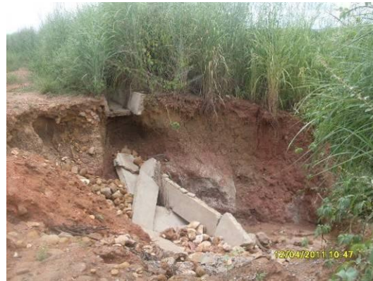
Foto 4-140 Erosão no talude de corte, estaca 16964.
