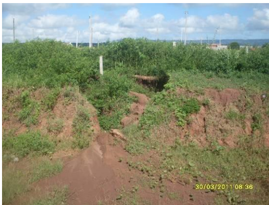
Foto 4-127 Erosão no talude de corte, estaca 15705.
