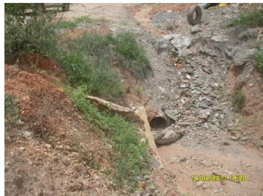
Foto 4-106 Bueiro obstruído estaca 13017.
