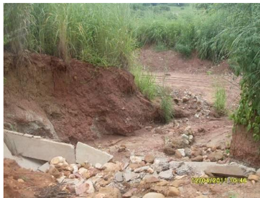
Foto 4-141 Erosão no talude de corte, estaca 16964.
