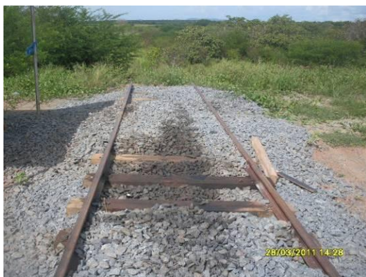
Foto 4-69 Mancha de óleo, contaminando a brita e possivelmente o solo sob esta, estaca 16933.
