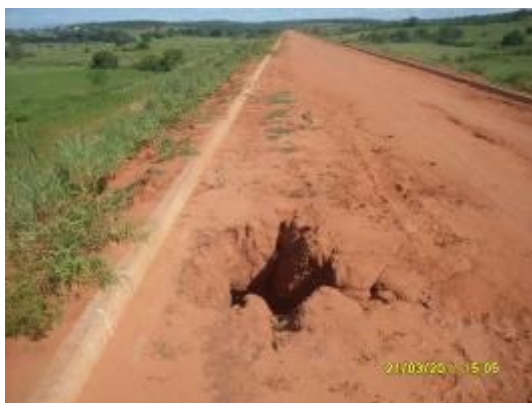
Foto 4-123 Erosões no talude de aterro, estaca 16528.
