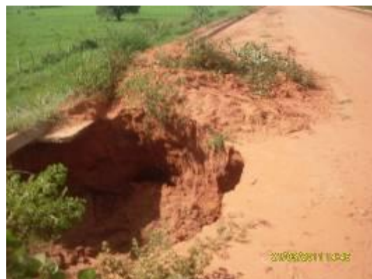
Foto 4-118 Erosões no talude de aterro, estacas 15929.
