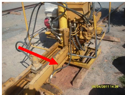
Foto 4-70 Máquina com vazamento de óleo contaminado o solo, estaca 16940.
