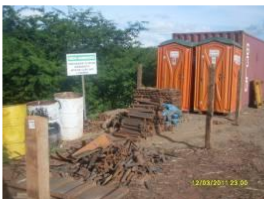
Foto 4-27 Banheiros químicos utilizados pelos colaboradores da TIISA, próximo à estaca 16936.
