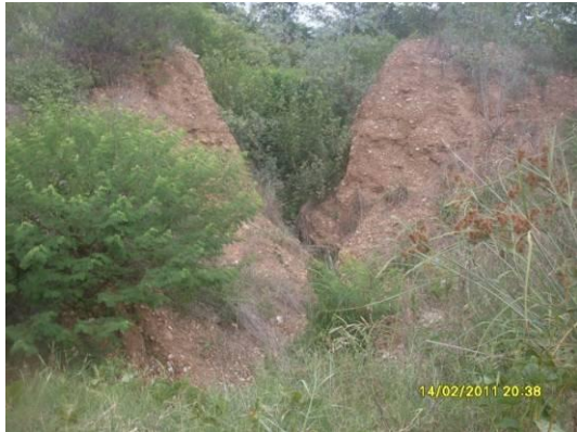
Foto 4-107 Bueiro obstruído estaca 12971.
