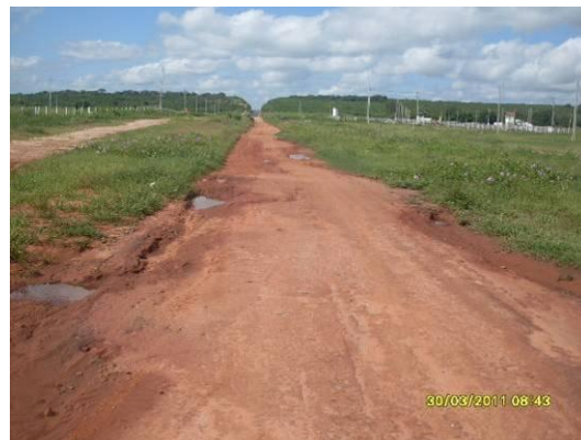
Foto 4-128 Erosão no lastro, Estaca 15704.
