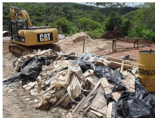
Foto 4-76 Resíduos misturados na ponte do riacho Jardim, estaca 14406.
