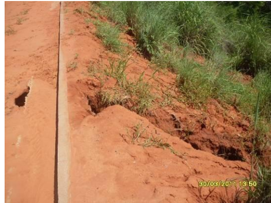
Foto 4-132 Erosão no talude de aterro, estaca 16023.
