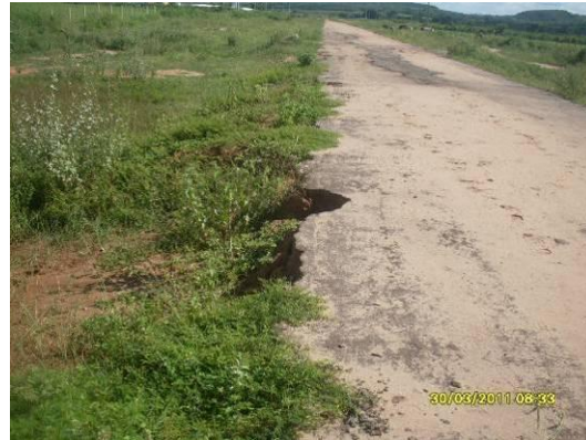
Foto 4-126 Erosão no talude de aterro estaca 15689.
