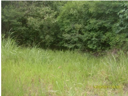
Foto 4-103 Talvegues obstruídos podendo causar degradação da vegetação estaca 12922.
