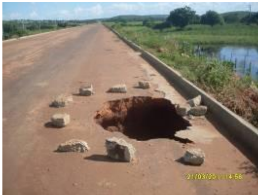
Foto 4-121 Erosões no talude de aterro, estaca 15973.
