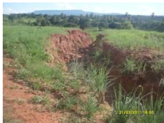
Foto 4-124 Erosões no talude de aterro, estaca 16517.
