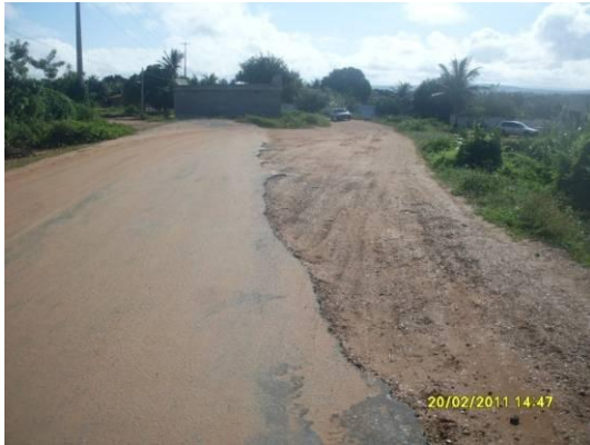
Foto 4-40 Desvio da passagem de Porteiras, continua com a sinalização precária, estaca 15436.
