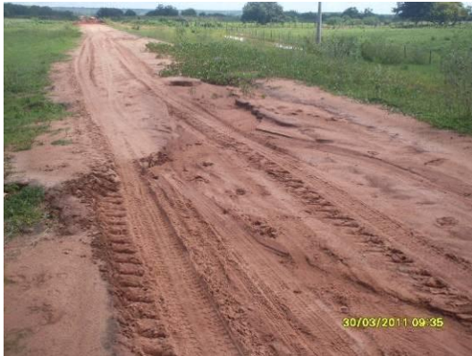
Foto 4-131 Erosão no lastro, estaca 15869.
