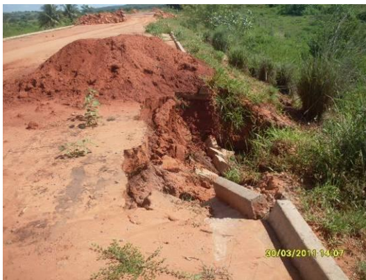
Foto 4-133 Erosão no talude de aterro, estaca 16003.
