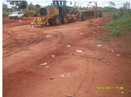
Foto 4-30 Serviços de terraplanagem, falta de ponto de apoio, banheiros químicos e tambores para colocar os resíduos, estaca 16233.
