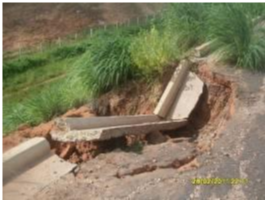
Foto 4-115 Sequências de erosões no talude de aterro, estaca 13812 à 13854.
