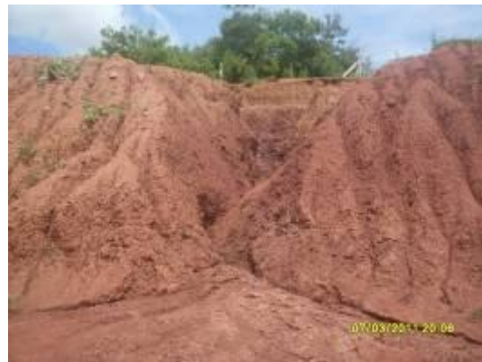
Foto 4-116 Erosões no talude de corte, estacas 14152.
