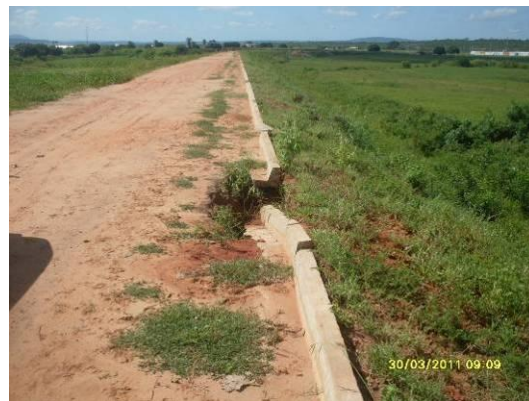
Foto 4-130 Erosão no talude de aterro, estaca 15756.
