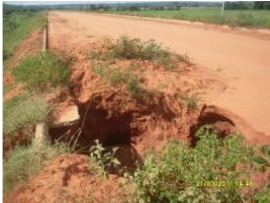
Foto 4-119 Erosões no talude de aterro, estacas 15947.
