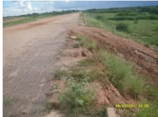
Foto 4-114 Sequências de erosões no talude de aterro, estaca 13769.
