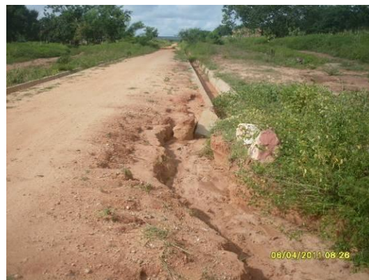
Foto 4-136 Erosão no lastro da ferrovia, estacas 15518.
