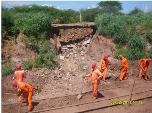
Foto 4-97 Erosão no talude de corte com carreamento do solo, sobre a superestrutura, chegando a soterrar os trilhos na estaca 16965.
