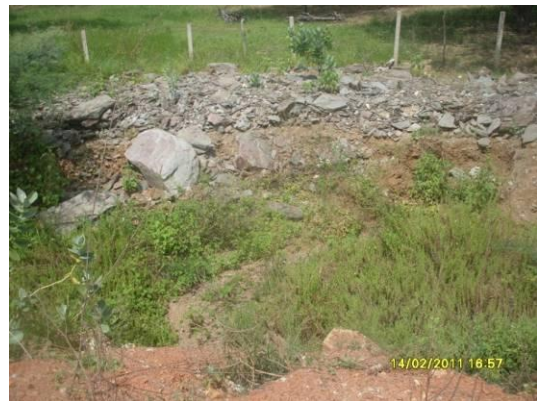
Bueiro obstruído estaca 13373.
