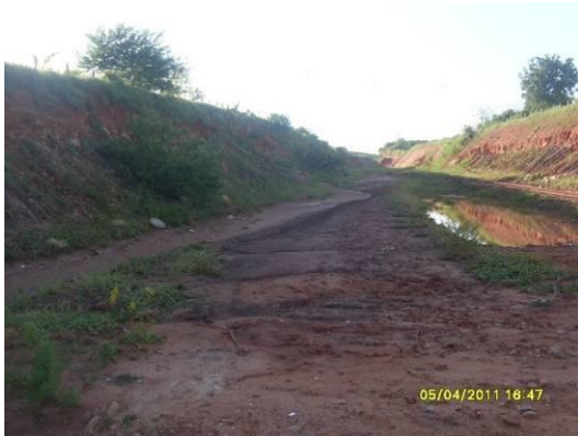
Foto 4-137 Erosão no lastro da ferrovia, estacas 16095.
