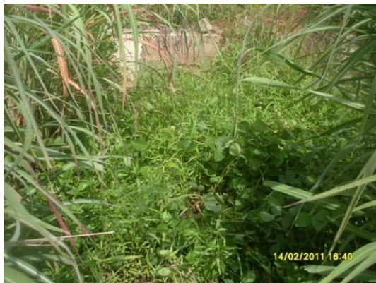
Bueiro obstruído estaca 13428.
