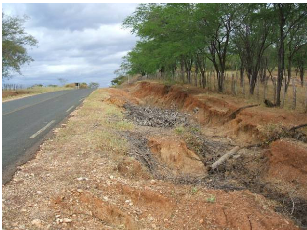
Foto 4.1-33 – AID/ADA – Ravinas desenvolvidas em metapelitos da Formação Pimenteiras por escoamento concentrado de águas pluviais ao longo do leito da rodovia Paes Landim a Simplício Mendes.
