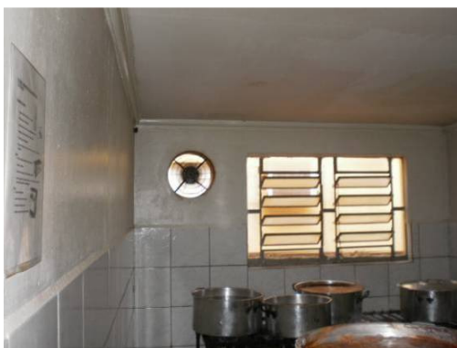
Foto 4-44 Exaustor funcionando após conserto. Cantina Parnamirim-PE.
