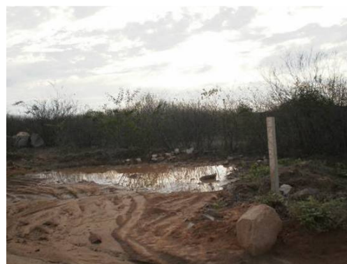
Foto 4-27 Correção (retirada de material fora da faixa de domínio). Estaca 783
