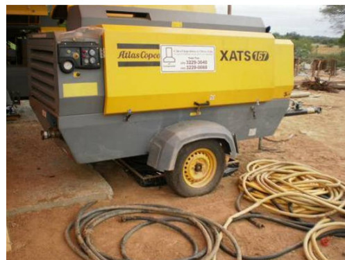
Foto 4-25 Gerador com bandenja de conteção e sem vazamentos. Estaca - 3032 Rio Brígida.
