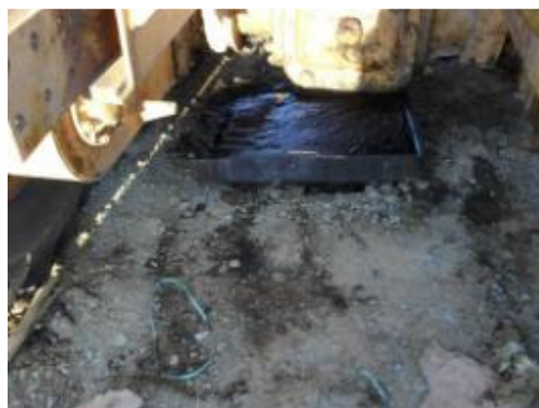
Foto 4-34 Equipamento com bandeja mas contaminando o solo
