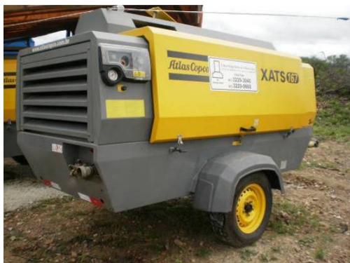
Foto 4-24 Gerador com fazamento e sem bandeja de contenção. Estaca 3032 Rio Brígida
