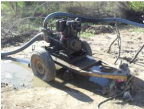
Foto 4-37 Moto bomba sem bandeja de contenção de óleo. E- 2759
