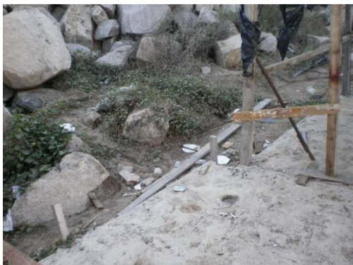
Foto 4-22 Resíduos espalhados. Estaca 619 ponte sobre o Rio Miguel
