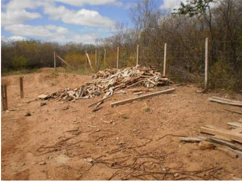
Foto 4-28 Resíduos (resto de obra) espalhados. Estaca – 187
