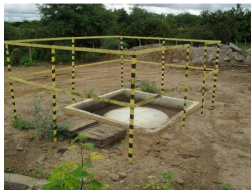
Foto 4-48 SAO – Separador de Água e Óleo. Canteiro Administrativo.
