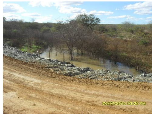
Foto 4-67 Tavegue obstruído e vegetação afetada. Estaca – 1890 Lote III.
