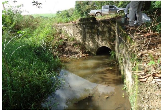
Foto 7.1-12 - Rio Preto. Detalhe do lançamento de efluente no corpo d'água.
