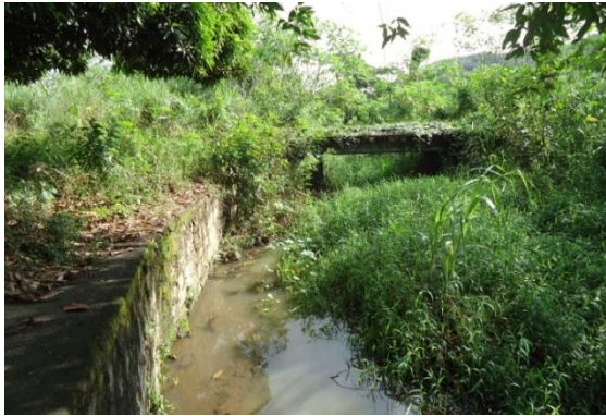
Foto 7.1-11 - Ponto 04 - Rio Preto. Detalhe do muro de concreto e da grande quantidade de vegetação invadindo o curso d'água.
