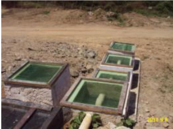
Foto 3-67 Sistema Separador de Água e Óleo – SAO do canteiro avançado.
