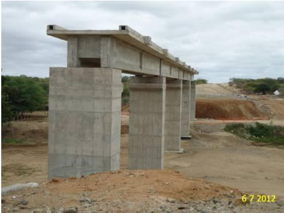
Foto 2-89 Ponte paralisada sobre o rio Marrecas.
