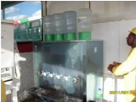
Foto 3-43 Bebedouro instalado em ponto de apoio operacional.
