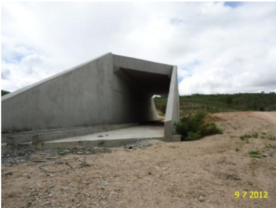
Foto 2-121 Passagem inferior restrita na estaca 50574.
