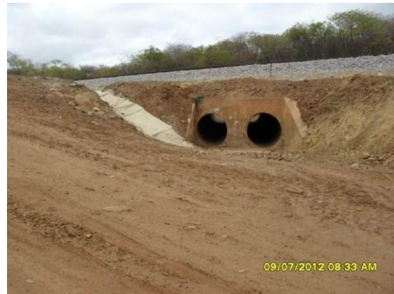
Foto 2-2 Bueiro Duplo Tubular de Concreto (BDTC) 1,20m de diâmetro, estaca 11131.
