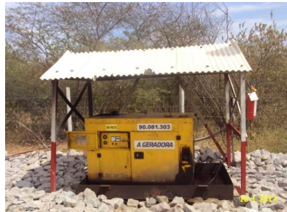
Foto 3-70 Geradores sobre bacias de contenção.
