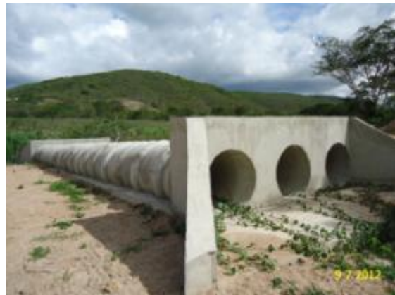
Foto 2-109 Bueiro triplo tubular de concreto (BTTC).
