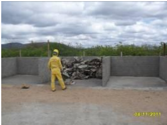
Foto 3-69 Baia de segregação – Lote 4..
