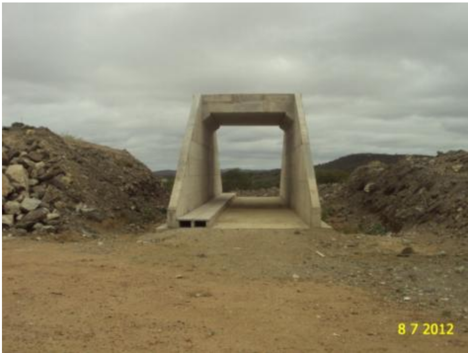
Foto 2-72 Passagem inferior restrita na estaca 32515.
