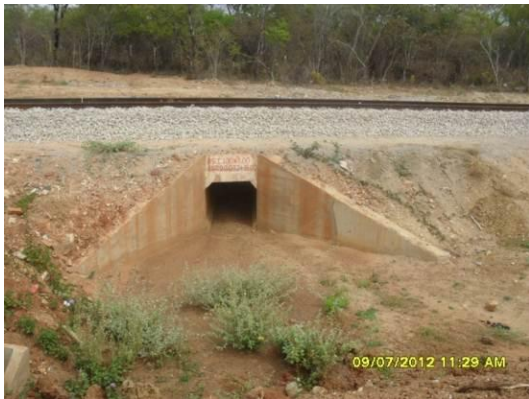
Foto 2-23 Bueiro Simplex Celular de Concreto (BSCC), Primeiro bueiro do lote na estaca 20032.
