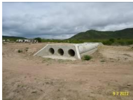
Foto 2-84 Bueiro triplo tubular de concreto (BTTC).
