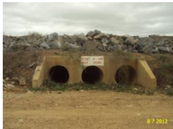
Foto 2-58 Bueiro triplo tubular de concreto (BTTC).
