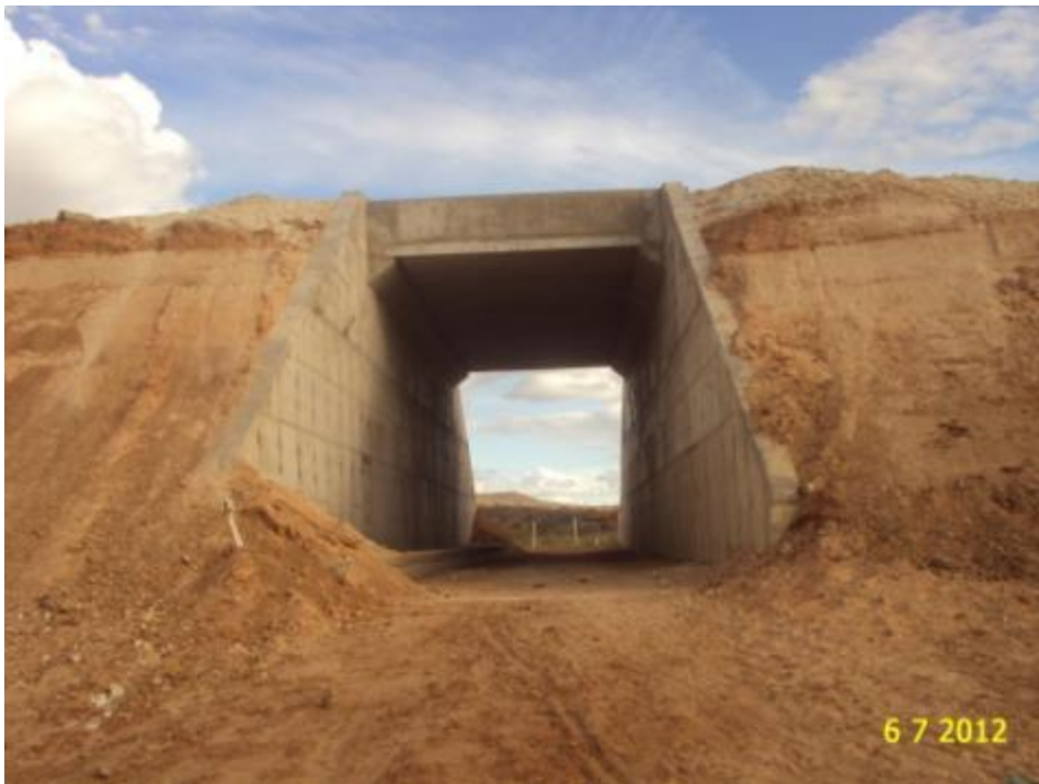
Foto 2-68 Passagem inferior restrita na estaca 31173.
