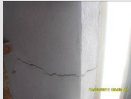
Foto 4 – Rachadura na parede.
