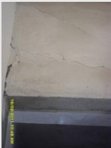
Foto 3 – Rachaduras que segundo a entrevistada foram provocadas pelas detonações.
