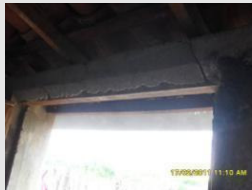
Foto 4 - Rachaduras provenientes das detonações, segundo a entrevistada.
