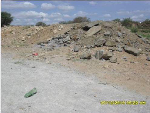
Foto 1- Aterro a beira do açude.
