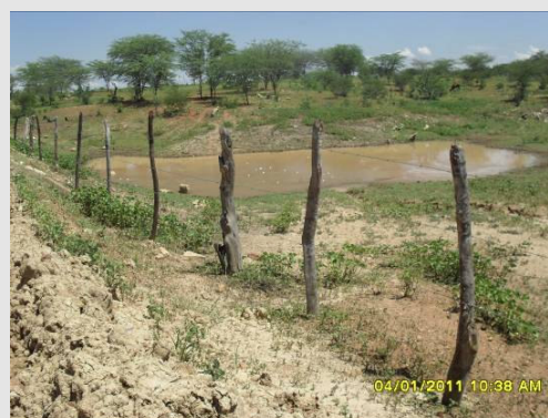
Foto 4 – Barragem que se encontra com o sangrador interrompido.
