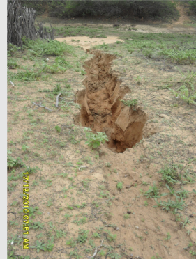
Foto 2 – Cratera formada pelo à retenção da água da chuva.
