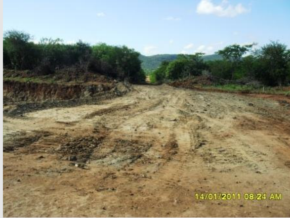
Foto 1 – Ausência de cerca em um dos lados da faixa de domínio.
