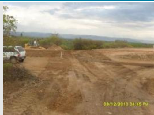
Foto 2 – Visão ampla do local do cruzamento na estaca 22.251.
