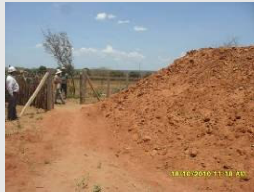
Foto 2 - Aterro próximo a casa causando muito poeira.
