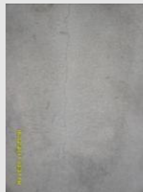
Foto 2 – Rachadura que segundo a entrevista é proveniente das detonações.
