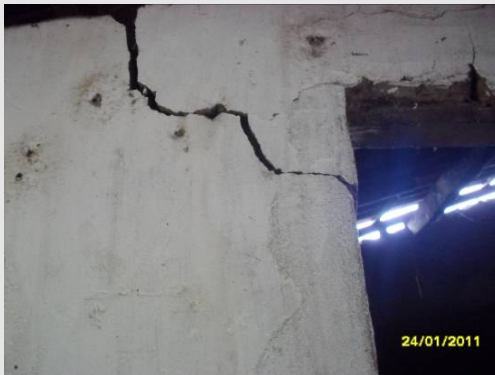
Foto 3 – Rachadura que o entrevistado diz ser proveniente das detonações.
