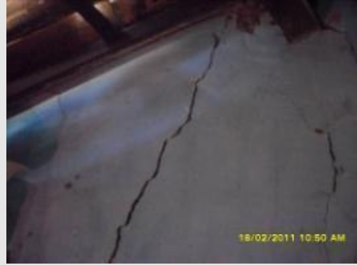
Foto 2 – Rachaduras apresentadas após as detonações.
