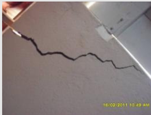
Foto 4 - Rachaduras que segundo a entrevistada foram provocadas pelas detonações.
