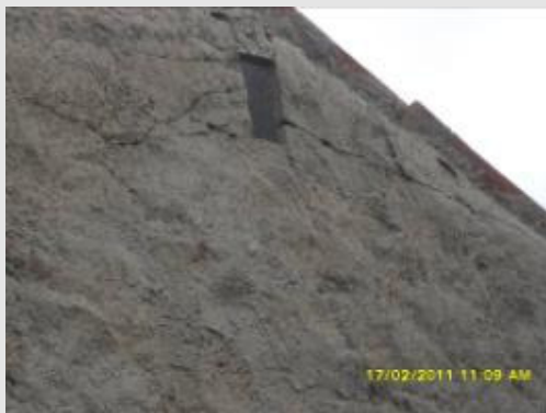
Foto 3 - Rachaduras provenientes das detonações, segundo a entrevistada.
