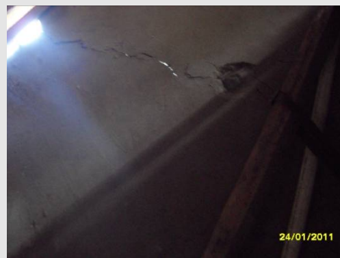
Foto 4 - Rachadura que o entrevistado diz ser proveniente das detonações.
