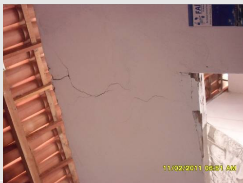
Foto 3 – Rachaduras provenientes das detonações segundo o Proprietário.
