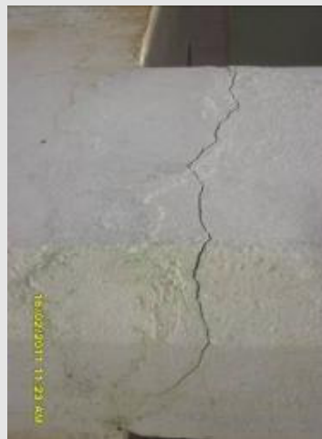
Foto 2 – Rachadura que segundo o entrevistado foi devido às detonações é a utilização do rolo que trabalha próximo da residência.
