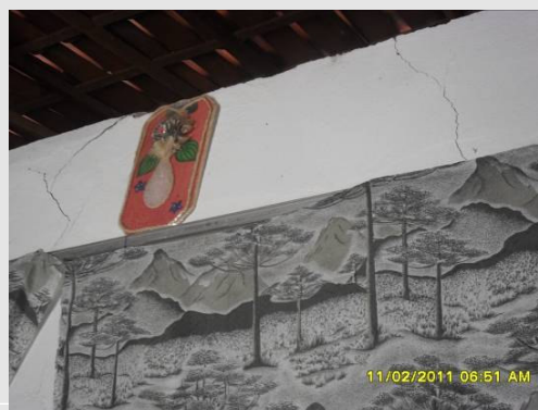
Foto 4 - Rachaduras provenientes das detonações segundo o Proprietário.
