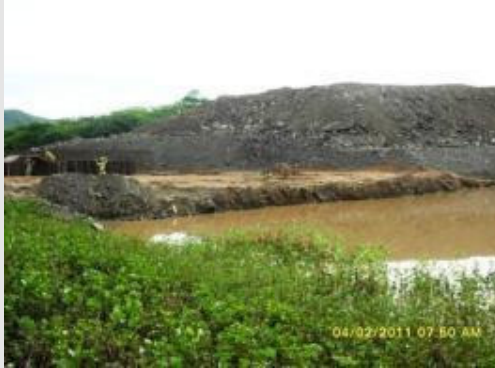
Foto 1 – Reservatório de água atingido pela obra.
