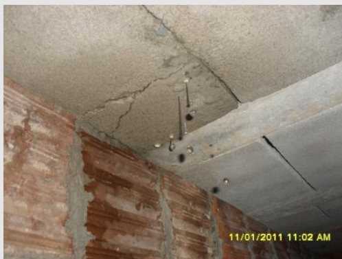
Foto 3 – Vazamento causado por rachaduras decorrente das detonações.
