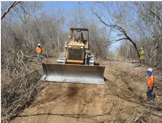
Foto 7 – Atividade de supressão de vegetação por trator no Lote 4.
