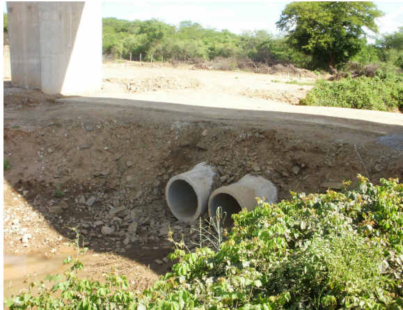
Foto 5.1.1-1– Riacho São José (PE 01B): ausência de escoamento superficial.
